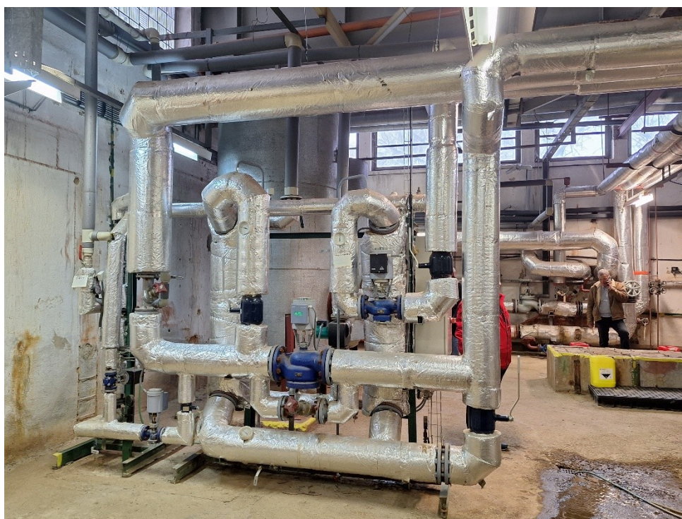
Obr. č. 1.1.5h – Výměník TUV (pavilon D´)
