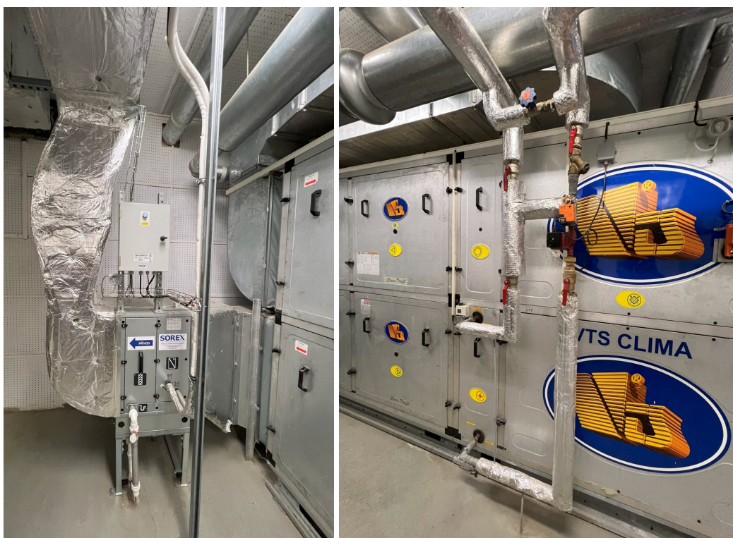
Obr. č. 1.1.3d – VZT jednotka
