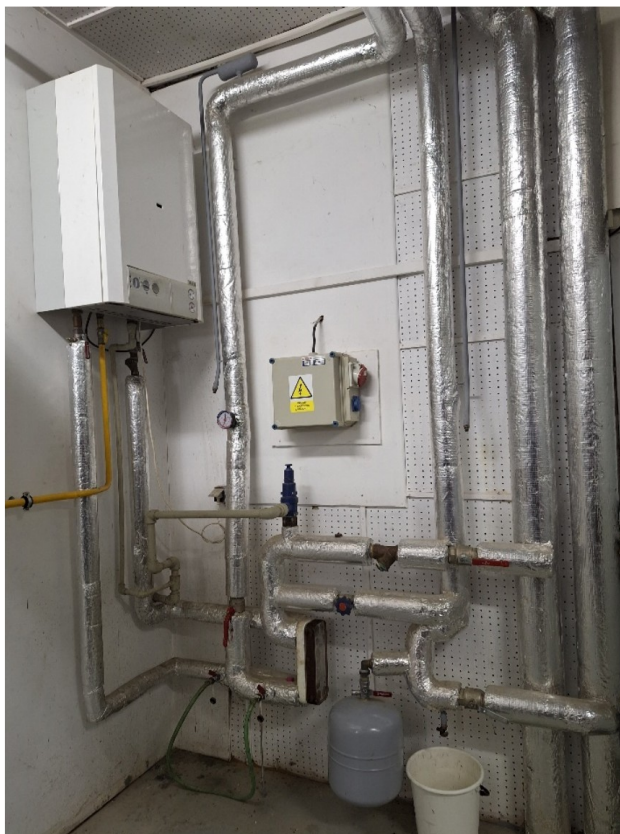
Obr. č. 1.1.3e – Teplovodní výměník + plynový kotel
