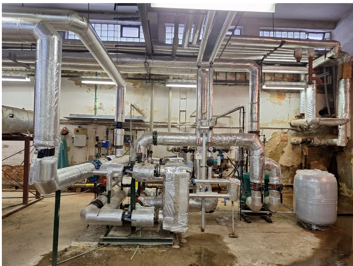
Obr. č. 1.1.5d – Výměňík ÚT (pavilon D)
