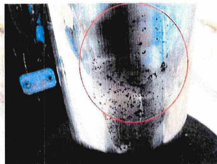
Koroze hlavního hydraulického válce - detail
