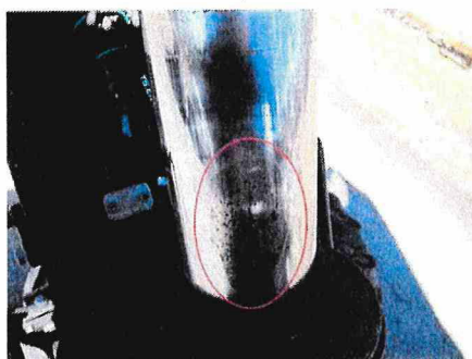
Koroze hlavního hydraulického válce
