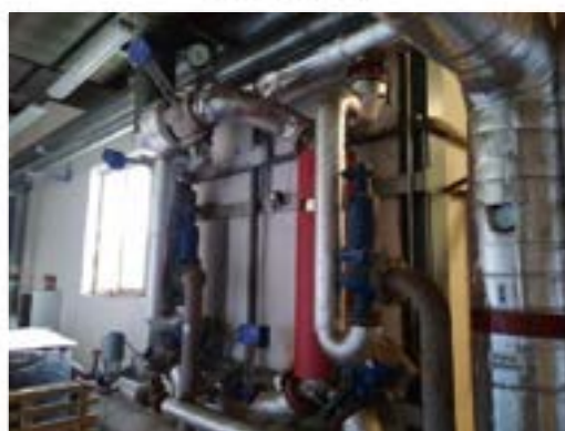
výměník pára / horká voda
