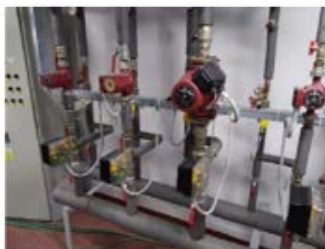
rozdělovač otep. vody ve strojovně VZT (6.NF)
