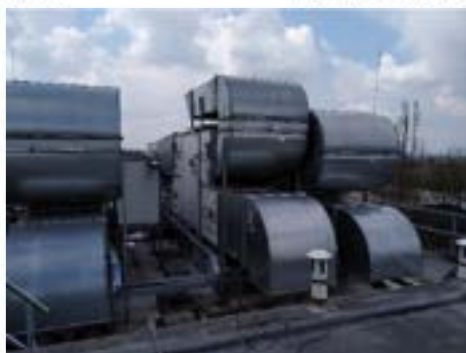
VZT jednotky umístěné na střeše objektu chirurgie
