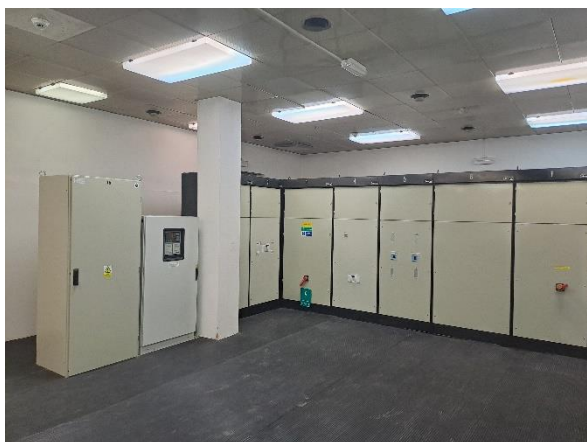
Obr. 1 – Rozvodna NN – celk. pohled
