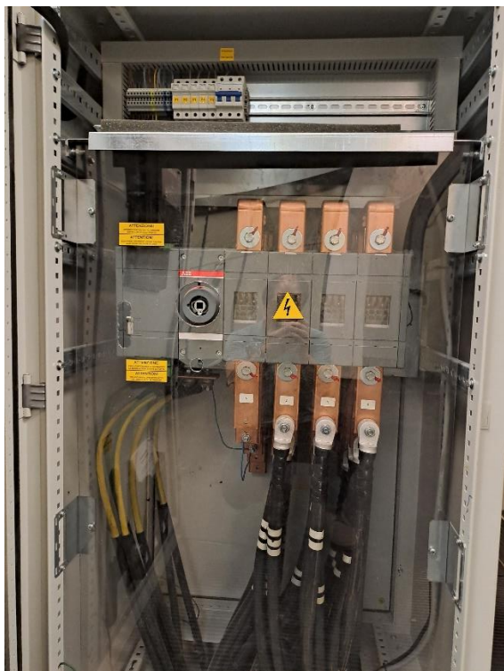
Obr. 9 – Stávající rozváděč R-ATS
