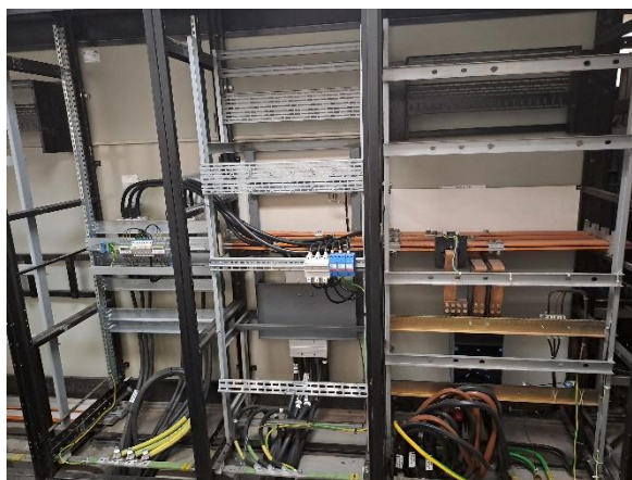
Obr. 2 – Rozváděč NN – pole r.5, r.4, r.3 (odleva)
