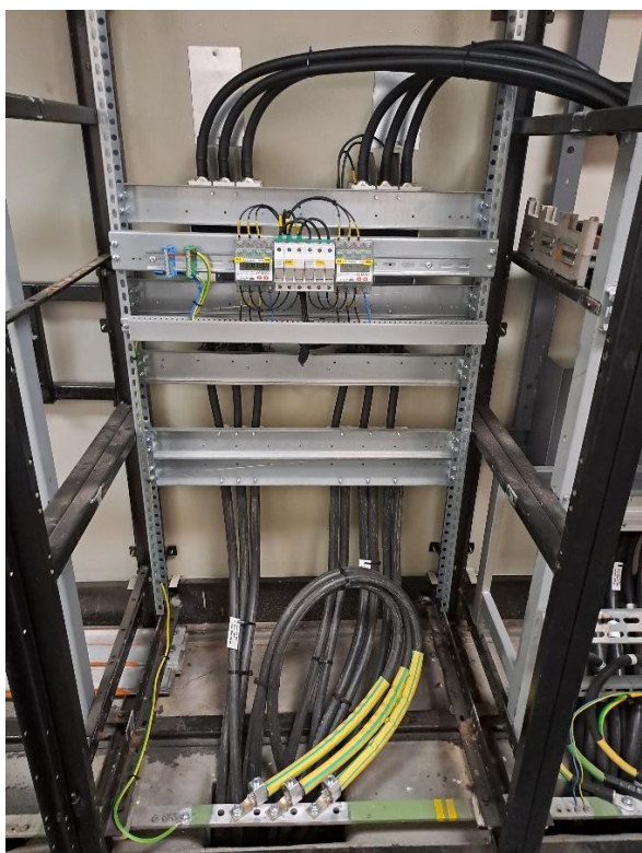
Obr. 3 – Rozváděč NN – pole r.5
