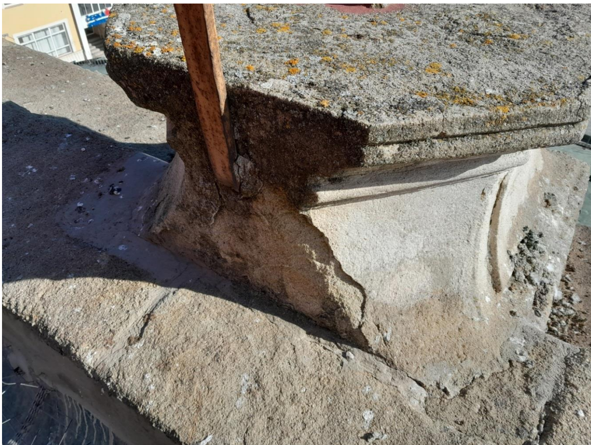
8) Koroze zadní části stávajícího podstavce původně nesoucí sochu Krista Spasitele.
