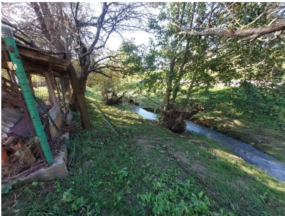
Obr. č. 6: Pohled proti proudu v ř. km 18,58 – nános sedimentu opět malý, pouze drobné „pupky“. Kolizní spíše dřeviny v průtočném profilu.
