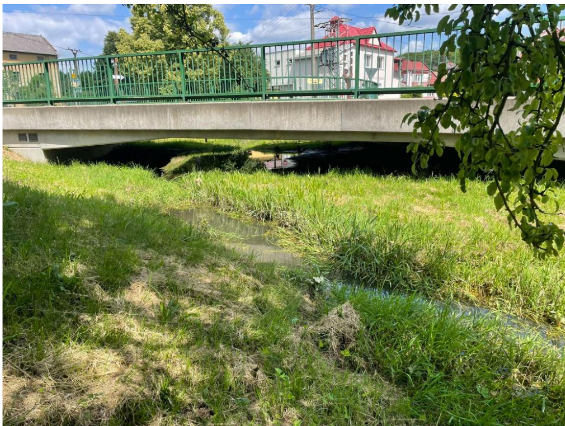
Obr. č. 5: Pohled proti proudu v ř. km 18,42 – výrazný nános sedimentu pod mostním objektem Ředitelství silnic Zlínského kraje.
