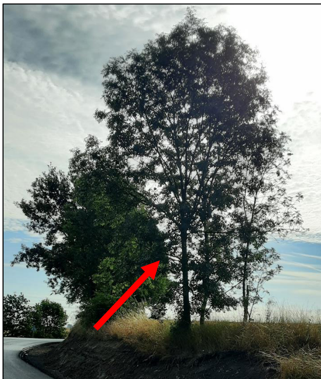
Obr.1: Položka č. 1001 (SO 105) – jaseň s poškozeným kořenovým systémem navržený na kácení (provozně nebezpečný strom).
