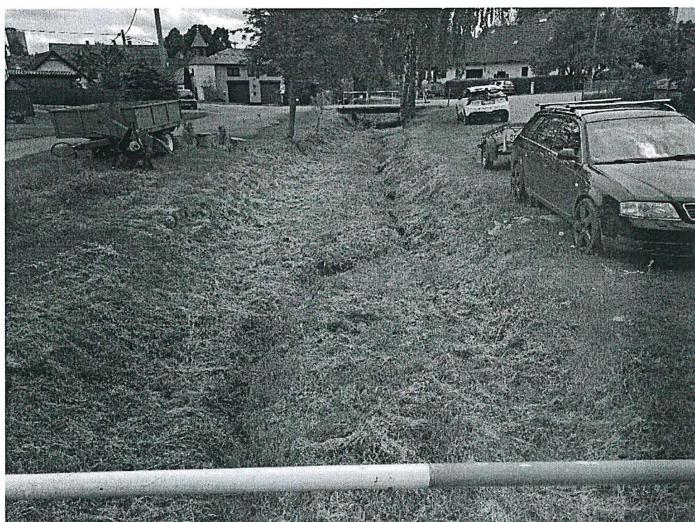
Úsek ř.km 5,60; velké množství sedimentů v profilu koryta toku
