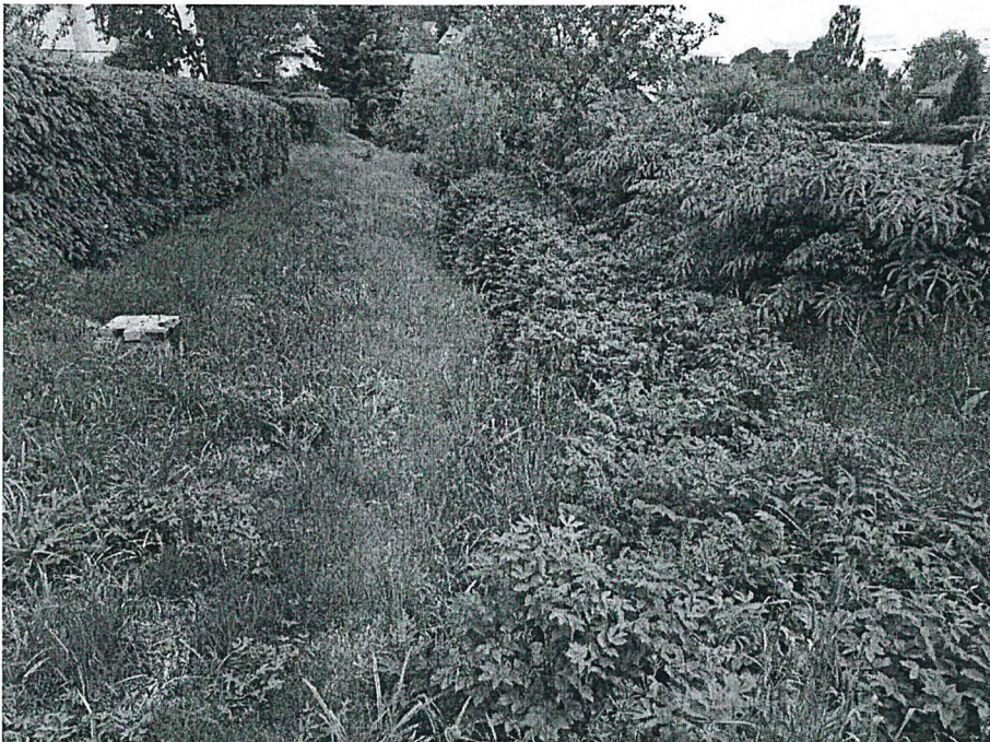
Úsek ř.km 5,74; sedimenty v téměř celém průtočném profilu
