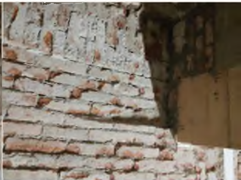
AS18_Pohled na poškozené cihly.jpg
