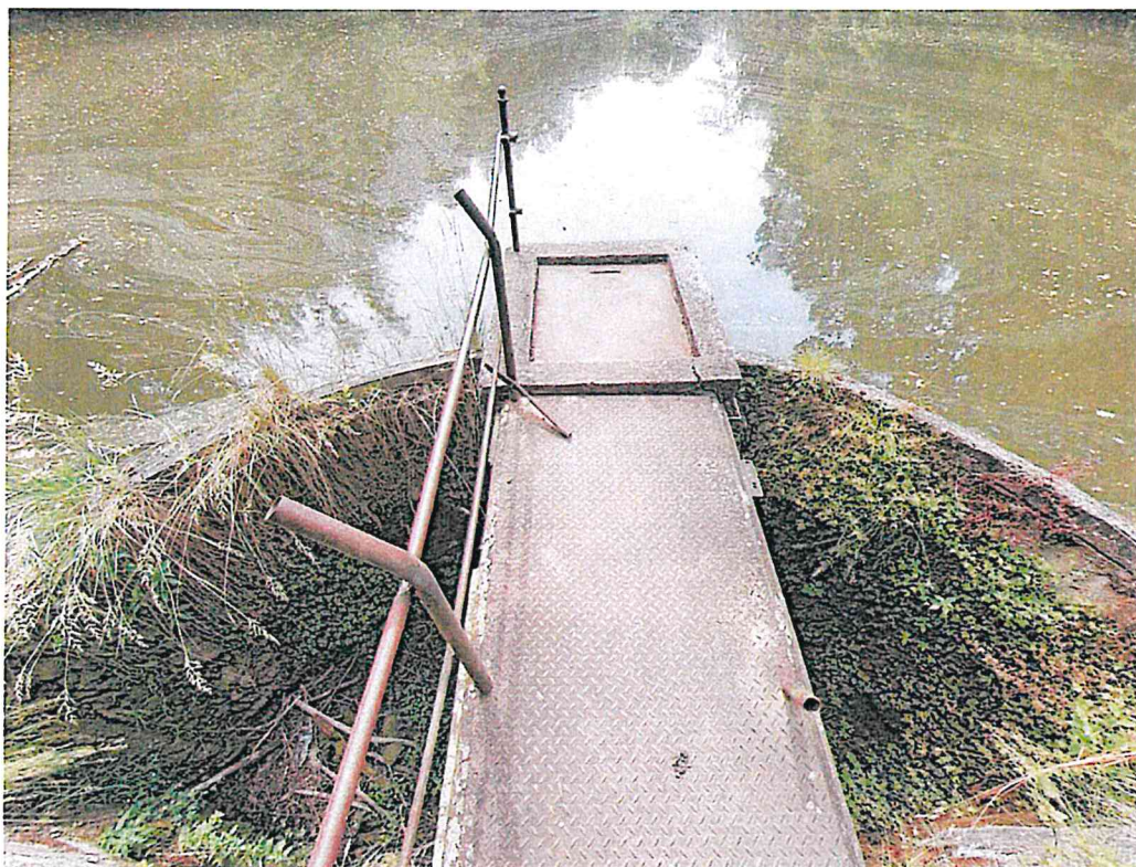
Foto č. 4: Pohled na degradaci betonového BP a výpustného zařízení včetně poškozených kovových konstrukcí
