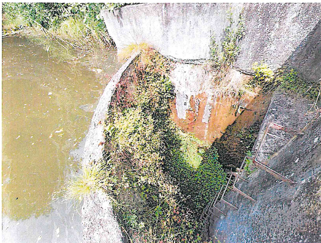
Foto č.5: Pohled do kašnového přelivu – degradace betonu je patrná v celé konstrukci.
