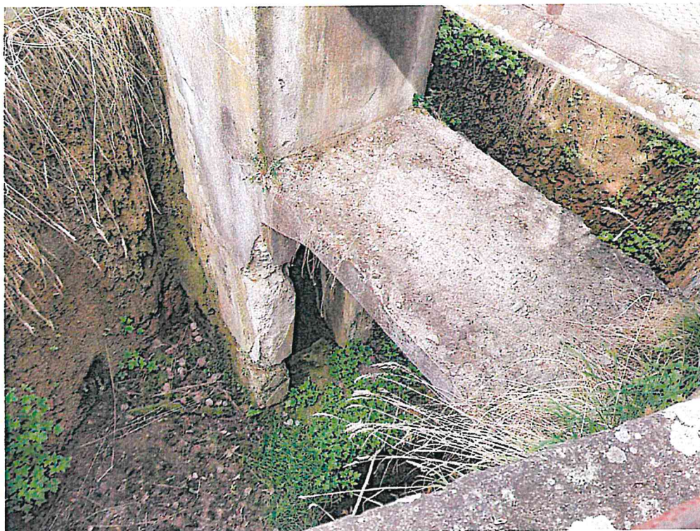
Foto č.6: Pokročilá degradace betonových konstrukcí přelivu sdruženého výpustního objektu
