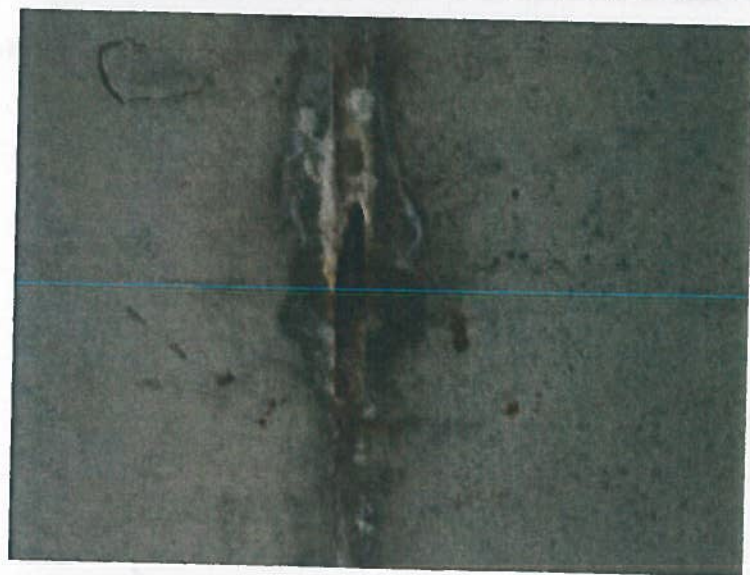
Detail výluhů ve spáře mezi nosníky
