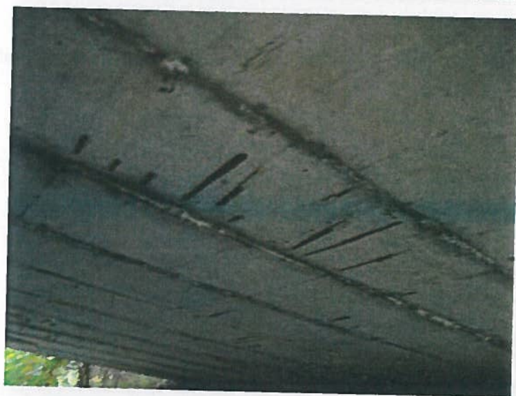
podhled NK, patrné zatékání spárami mezi nosníky
