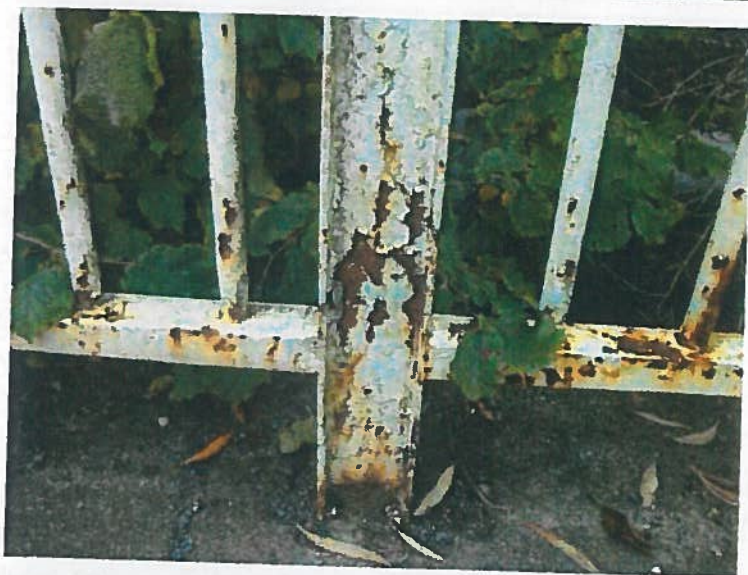
Detail koroze zábradlí
