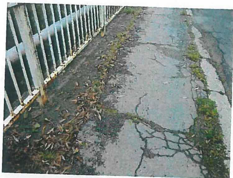
Trhliny v krytu chodníku na pravé straně
