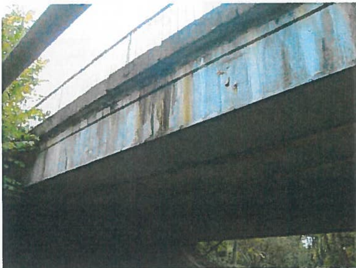
Zatékání na bok NK z pod římsy
