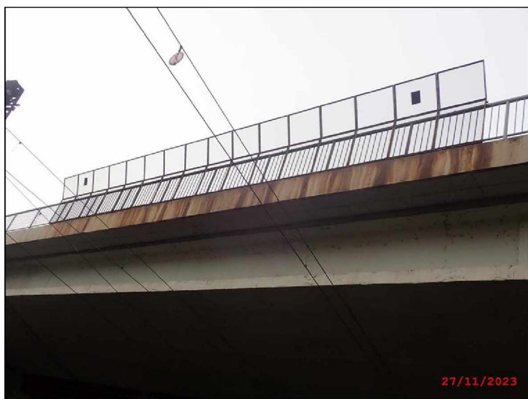
27-Římsa na PS celoplošně zasažena korozními splodinami z PDO.jpg
