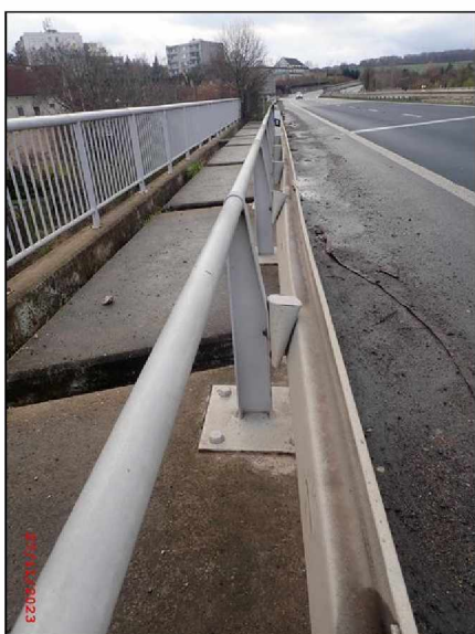
39-ZS v poli 1 poškozené deformační prvky nárazem vozidla.jpg
