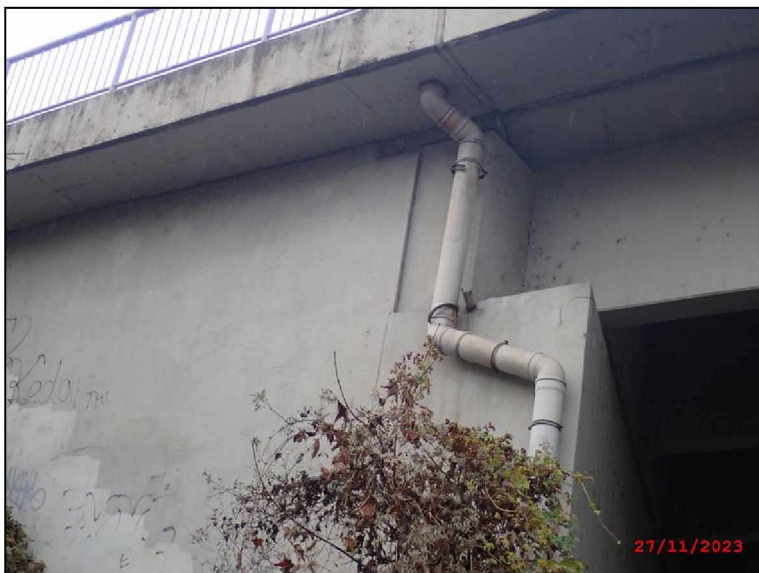
08-OP1 - uvolněný odvodňovací svod.jpg
