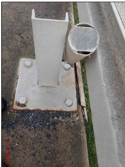
37-Uvolněná svodina na LS u OP3 odpadá hrana římsy.jpg
