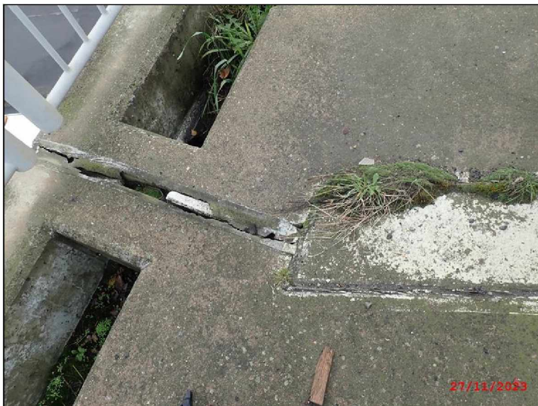
31-Odtržené těsnící tmely u všech dilatačních spár - nejvíce nad P2 PS.jpg
