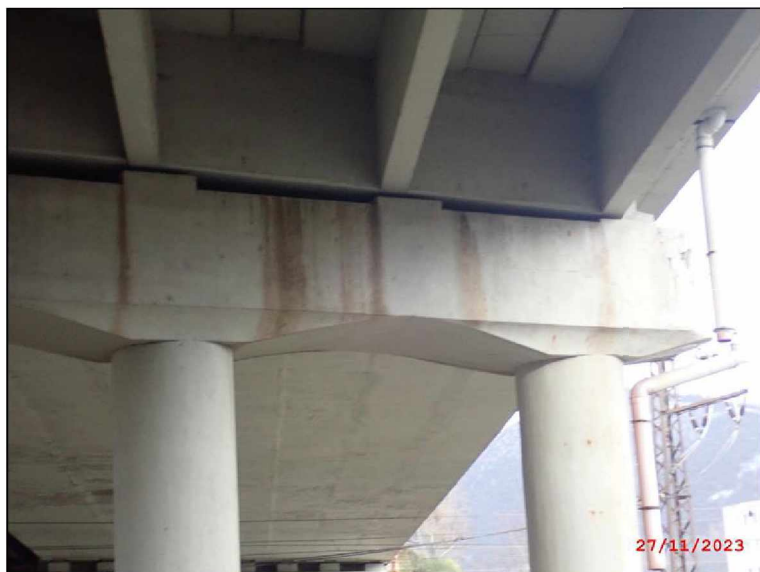
13-P2 - známky zatékání na ÚP PS.jpg
