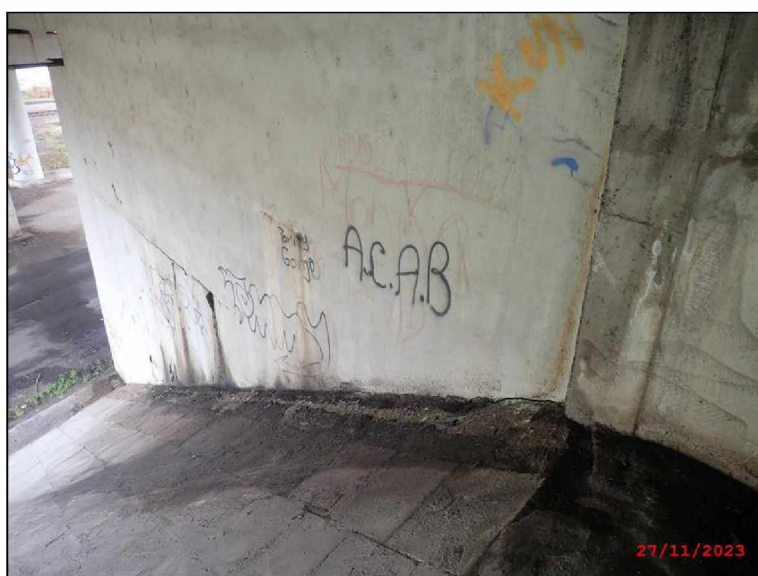
24-Křídlo u OP1 LS - prouchy v sanacích zatékání pracovními spárami.jpg
