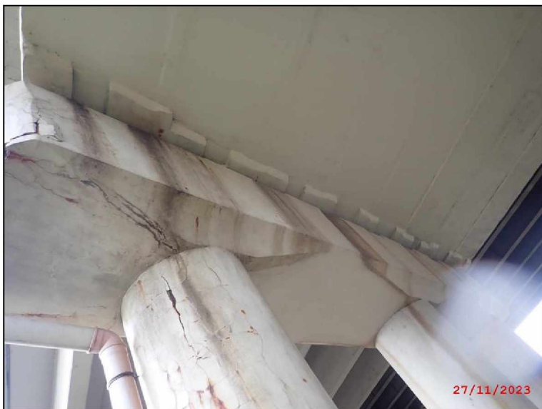
17-P2 spodní líc stativa známky zatékání na ÚP.jpg
