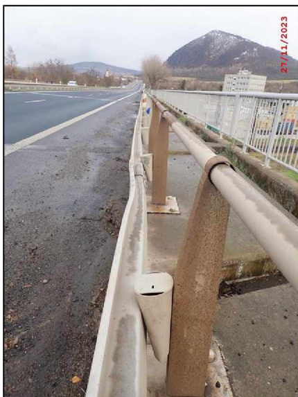
38-ZS v poli 1 poškozené deformační prvky nárazem vozidla koroze sloupků.jpg
