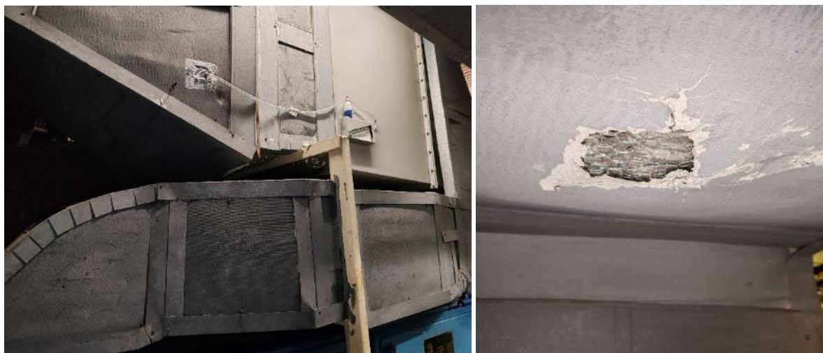
Fotografie výše ukazují krycí materiál izolace obsahující azbest ve strojovně 1C.
