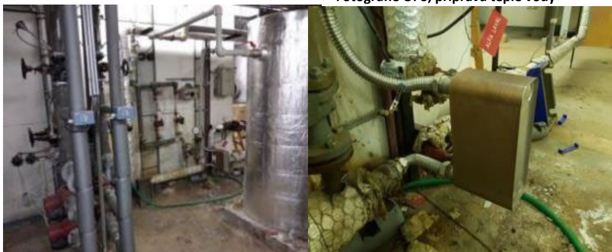
Fotografie OPS, příprava teplé vody
