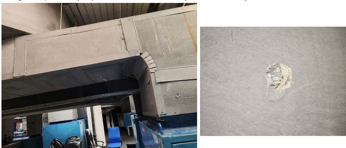
Fotografie výše ukazují krycí materiál izolace obsahující azbest ve strojovně 1A.
