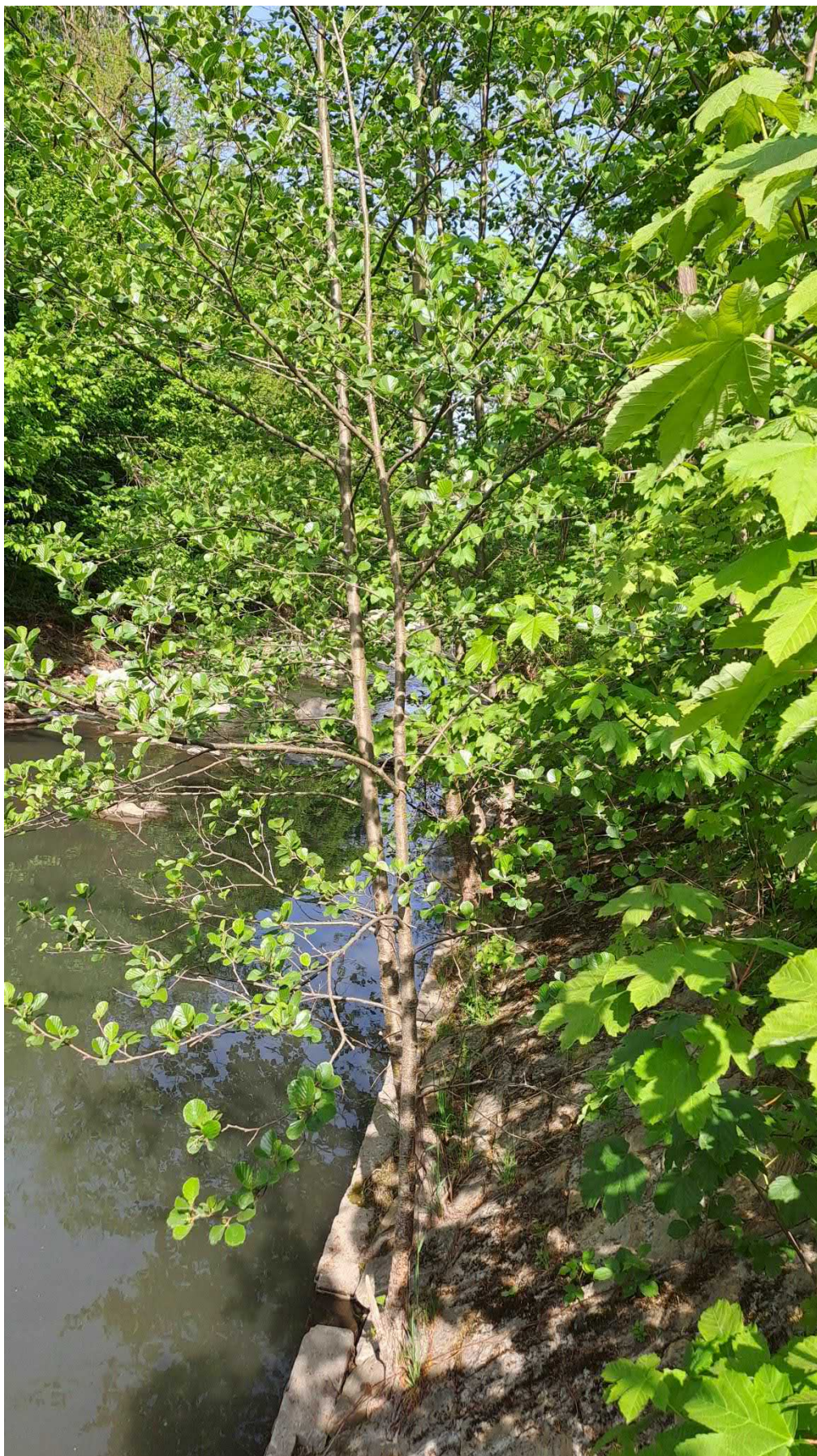
Nálety vyrůstající v břehovém opevnění toku (dlažba z LK na MC)
