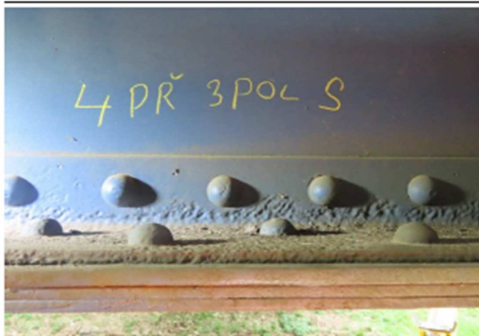
Foto č. 2 Konstrukce K 01 – 4. příčník 3. pole – oslabení
