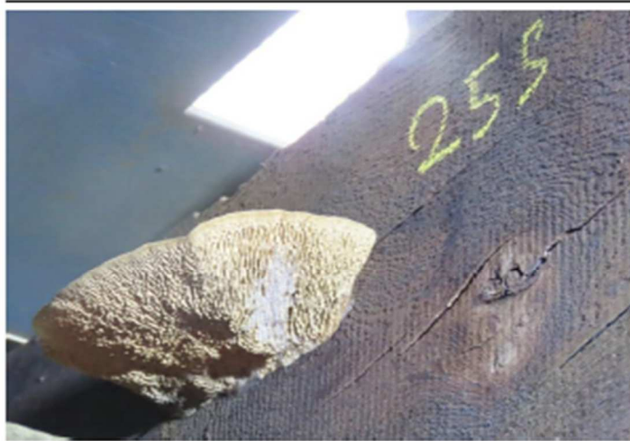
Foto č. 3 Konstrukce K 01 – mostnice č. 25 – dřevokazná houba
