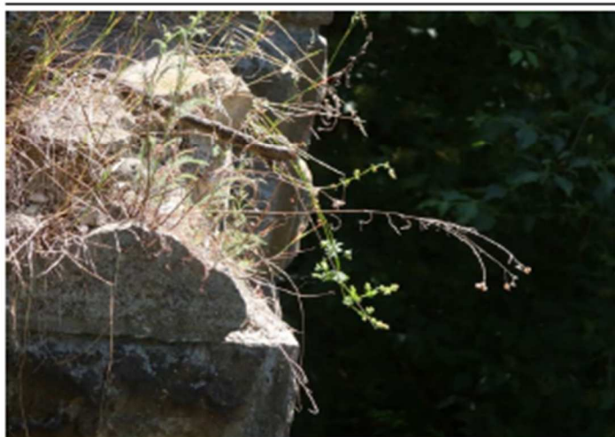
Foto č. 10 Piliř P 02 – – 2. otvor úložný práh vpravo degradovaný beton
