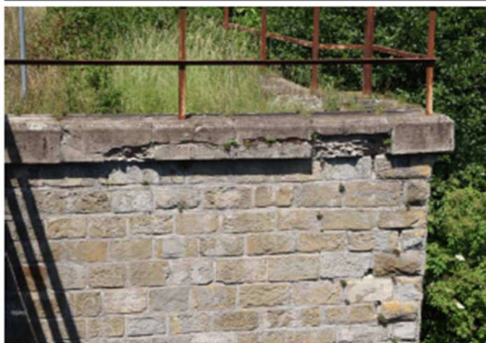
Foto č. 11 Piliř P 02 – – 2. otvor římsa vlevo – degradovaný beton
