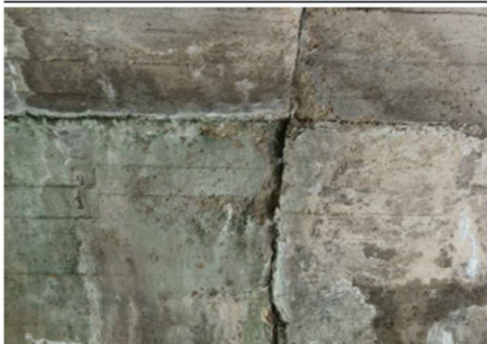
Foto č. 2 Konstrukce K 01 Líc dělicí spára – vrchol degradovaný beton, trhlin.
