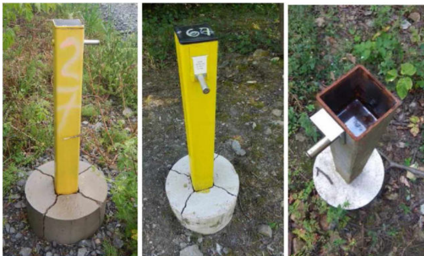
Obrázek 19 Popraskané betonové základy zajišťovacích značek ŽPSV
