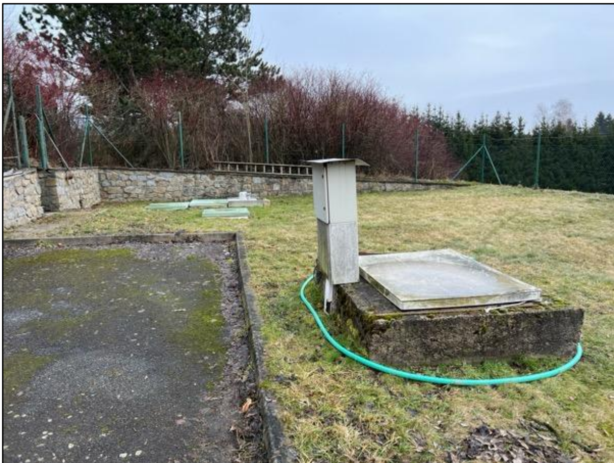
Obrázek 3: Pohled na sloupek elektro a stávající ČOV
