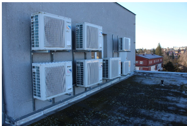
Obrázek 12 – Venkovní jednotky chlazení pro chodby a vybrané kanceláře
