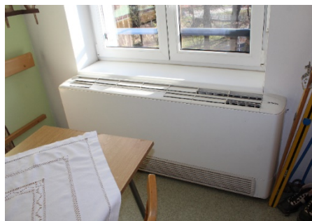
Obrázek 27 – 2 trubkový Fancoil na chodbách
