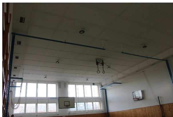
Obrázek 43: LED osvětlení v tělocvičnách
