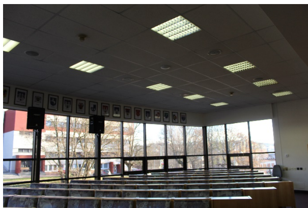
Obrázek 14 - Osvětlení zasedací místnosti v přístavbě
