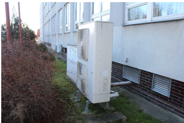
Obrázek 11 – Venkovní jednotky chlazení – pro zasedací místnost, server a tel. ústřednu
