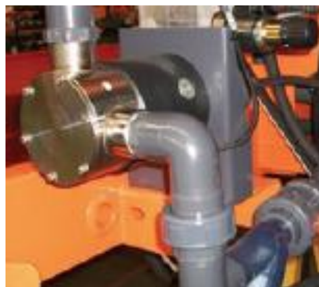
Nerezové čerpadlo solanky
