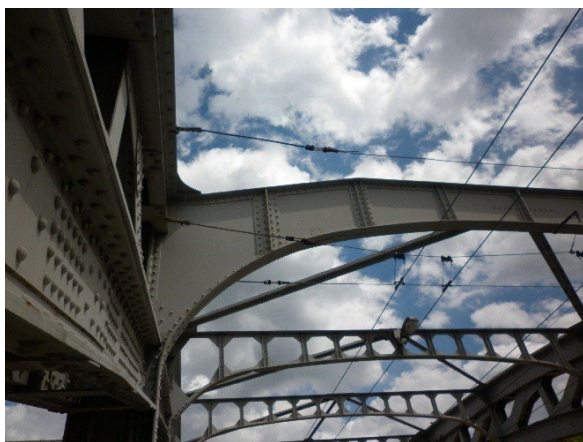
Obr. 25: Trakční vedení na mostní konstrukci
