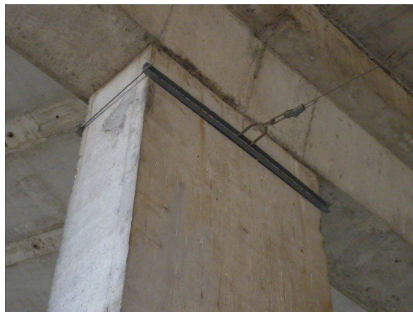
Obr. 28: Trakční vedení na mostním pilíři
