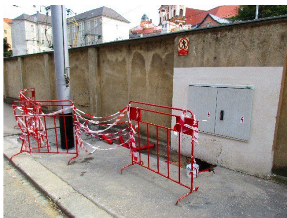
Obr. 51: Rozvaděč ve zdi
