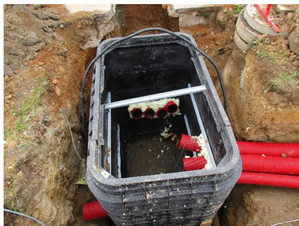
Obr. 47: Ochranná trubka v kabelové komoře
