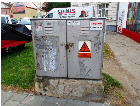
Obr. 50: Kabelová skříň – rozvaděč
