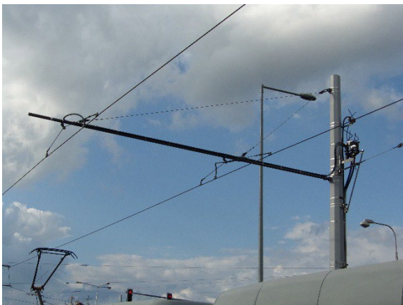
Obr. 42: Propojovací kabely na výložníku
