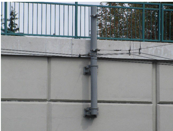
Obr. 27: Trakční vedení na zkráceném stožáru
