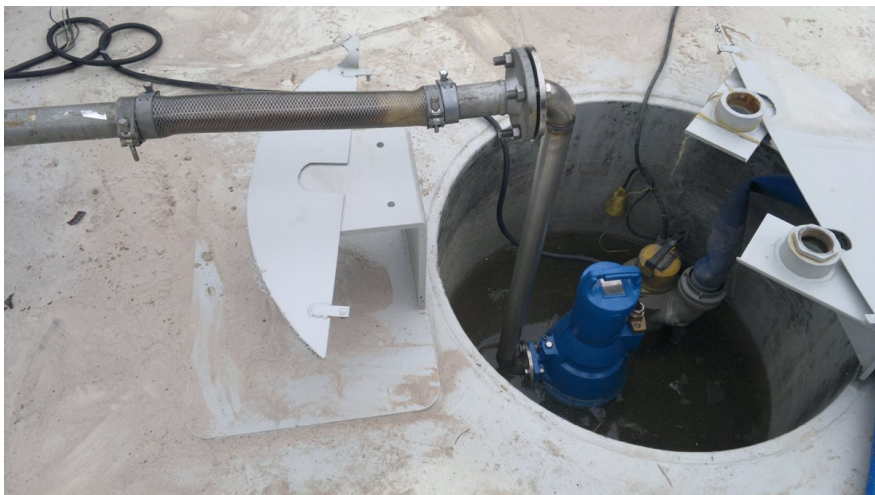
Obr. 4.5 První díl výtlačného potrubí odvodnění střechy
