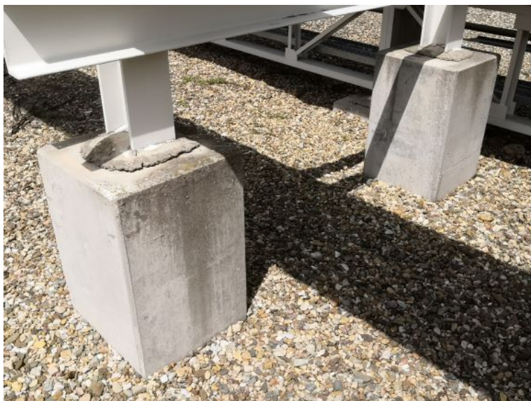
Obr. 7.2 Poškození betonových podpěrných patek
