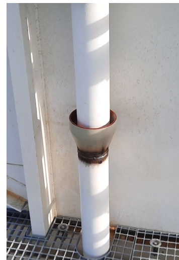
Obr. 3.11 Nové přerušení výtlaku st. čerpadla na ochozu nádrže
