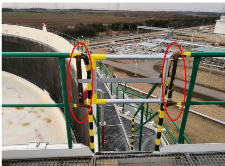
Obr. 3.12 Označená místa instalace
