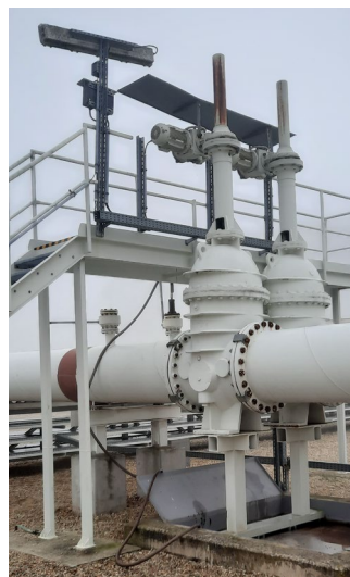
Obr. 2.5 Armatury MOV608217, MOV608218, včetně přechodové lávky
