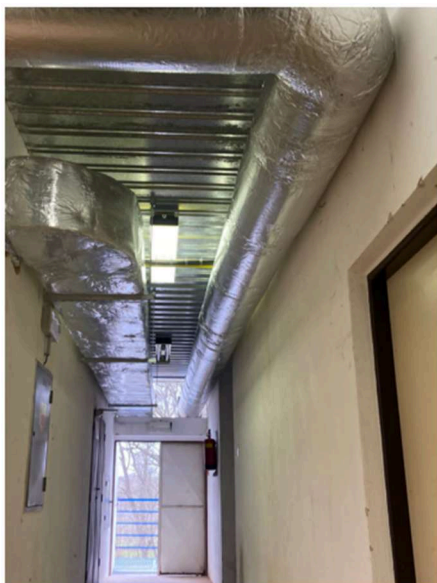
Ilustrativní foto – přiznané vzduchovody
