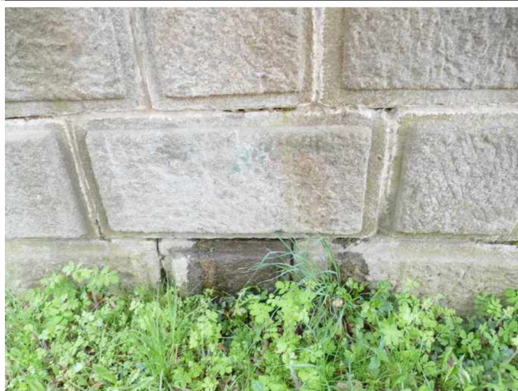
Opěra O 02: Průsaky vody
