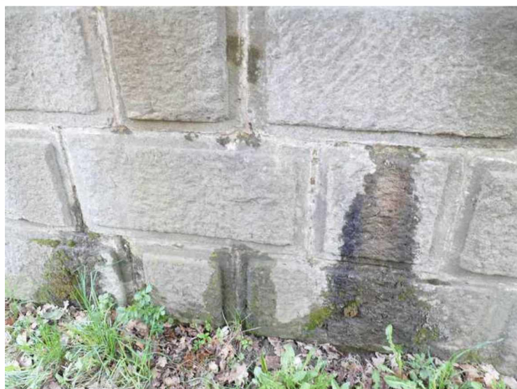
Opěra O 01: Průsaky vody
