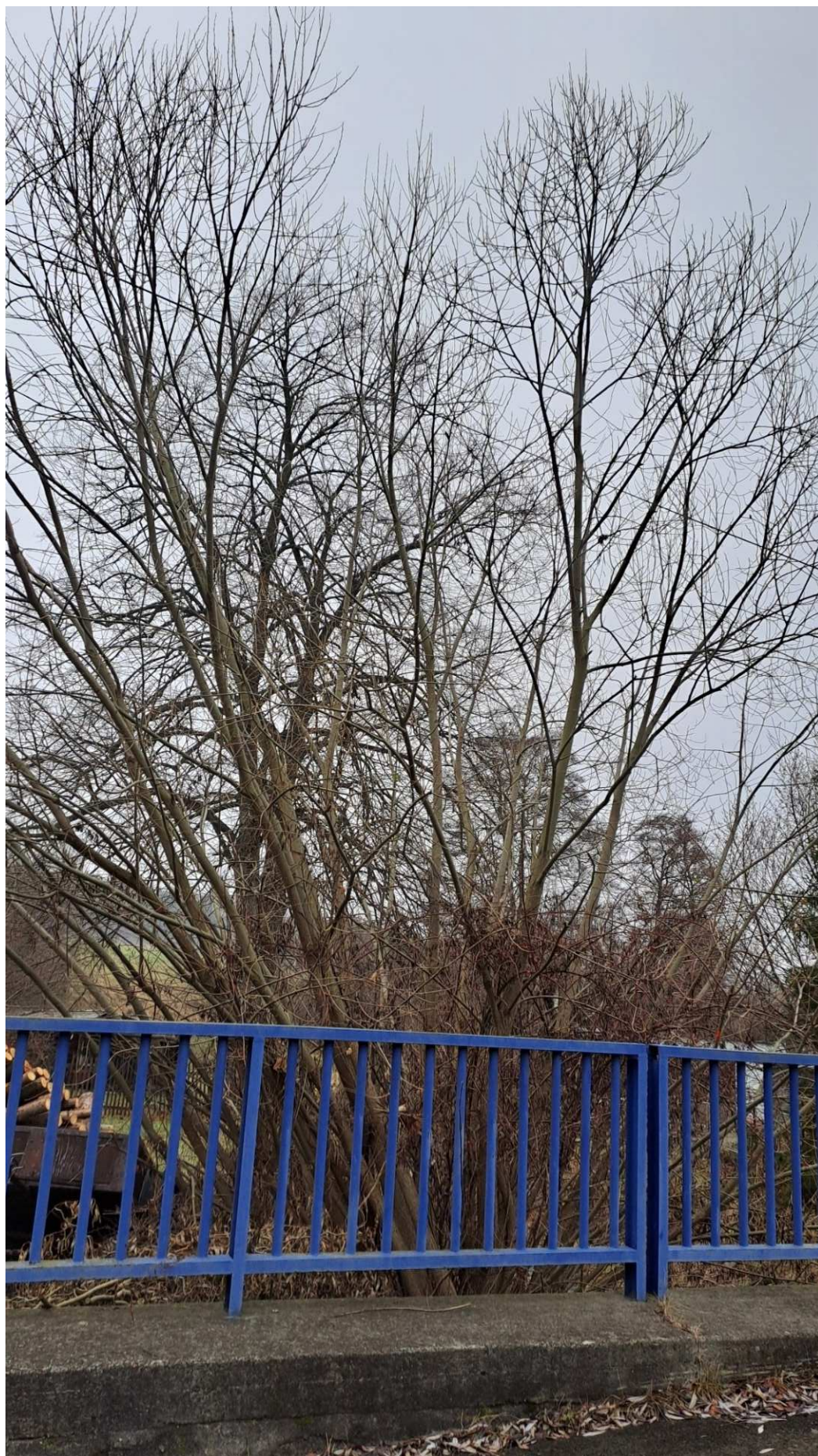
Vrbové porosty rostoucí v průtočném profilu na výtokové straně mostu, nadzemní vedení
