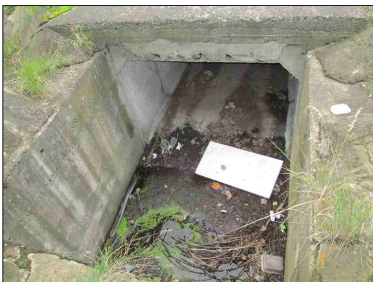
Pohled na most z LS Zanesená spadišťová šachta Separace dobetonávky čela
