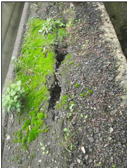
Pravá strana Přebalená vozovka Vymílání krajnice- pronikání vody pod římsou
