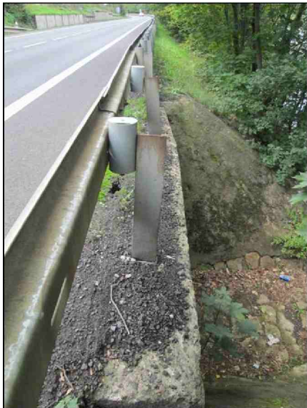
Pravá strana Koroze sloupku, nízké sloupky
