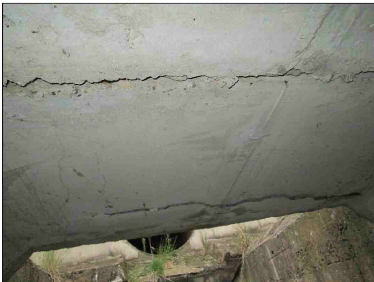
Pohled na příčel LS Separace krycí vrstvy podél vnější hrany
