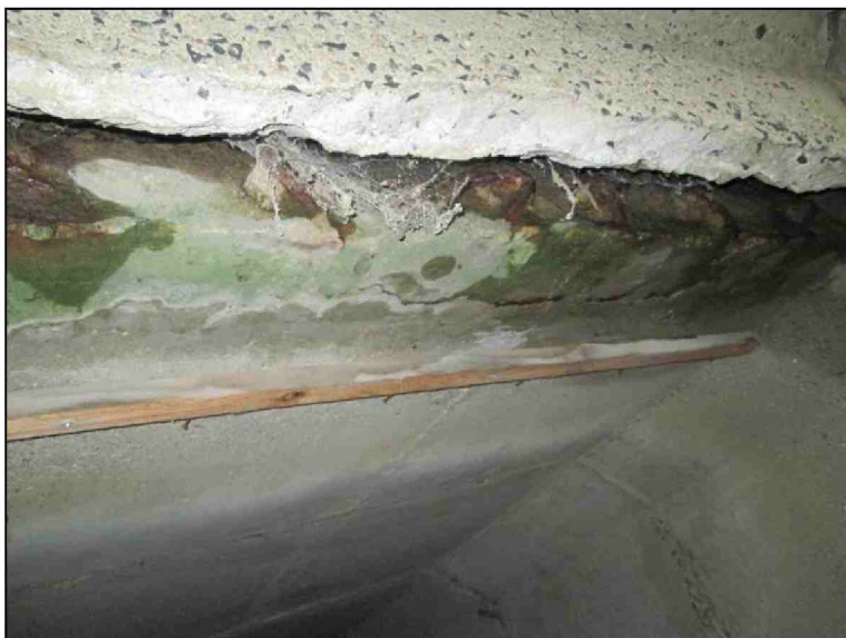
Pohled směrem k OP2 z PS Zatékání pod římsou na krajní díl
