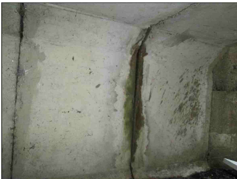
Pohled na OP1 LS Průsak spárou mezi 1-2 dílem
