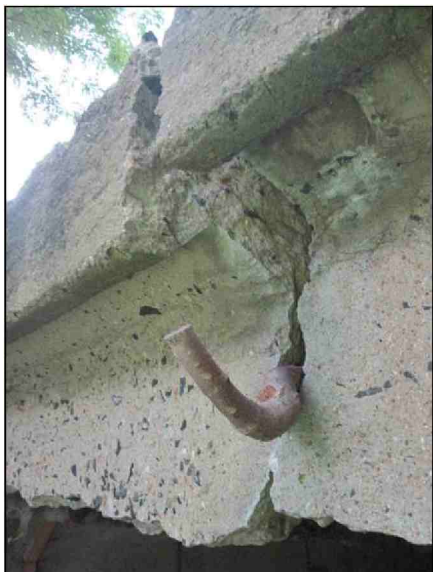
Pohled z PS směrem k OP1 Příčel Utržená obetonávka čela.
