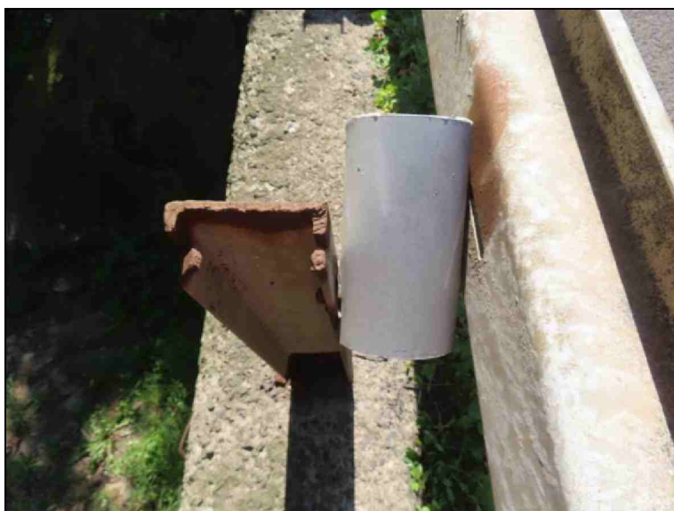
Pravá strana Koroze svodnic utržená svodnice
