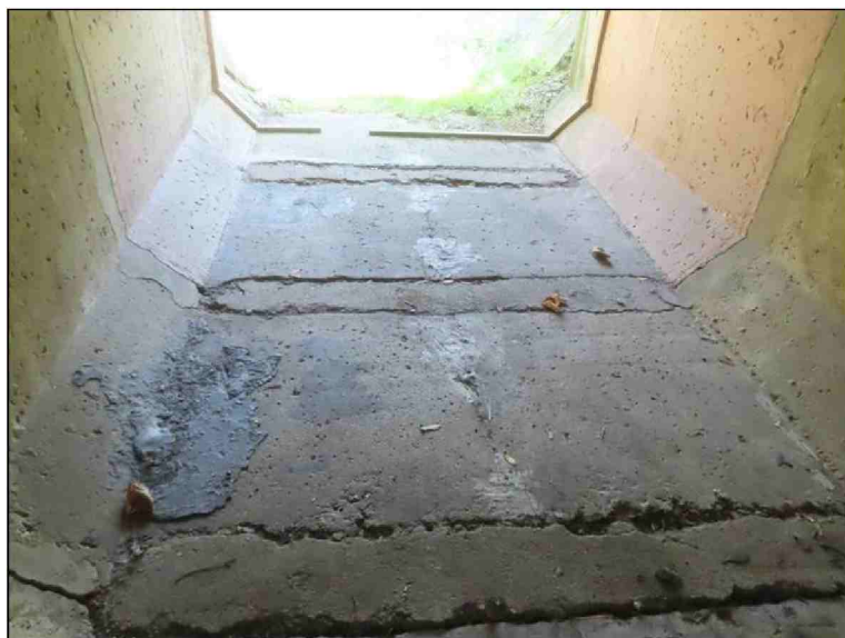
Pohled na PS Spodní příčel 7-9 díl- otevřené spáry
