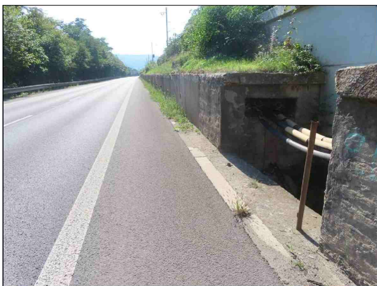
Pohled proti směru staničení Zábradlí - chybí
