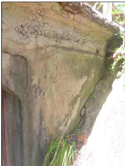
Pohled na OP2 a křídlo z PS Trhliny v omítce
