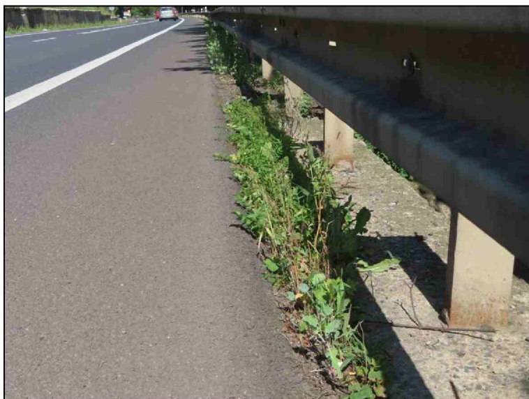
Pravá strana od OP1 Podemletá krajnice
