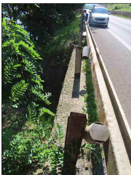
Pravá strana Koroze svodnic utržená svodnice
