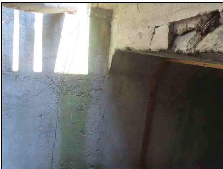
Pohled na příčel LS Odpadlá dobetonávka čela
