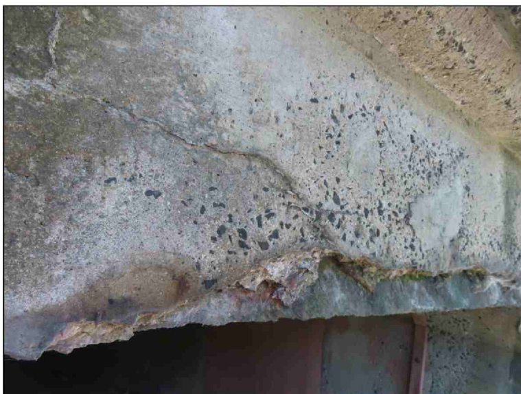
Pohled na příčel z PS Průsaky pod římsou Odpadlá dobetonávky čela
