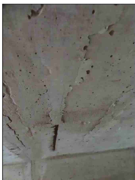
Pohled směrem k OP2 zleva 4. díl-obnažená výztuž
