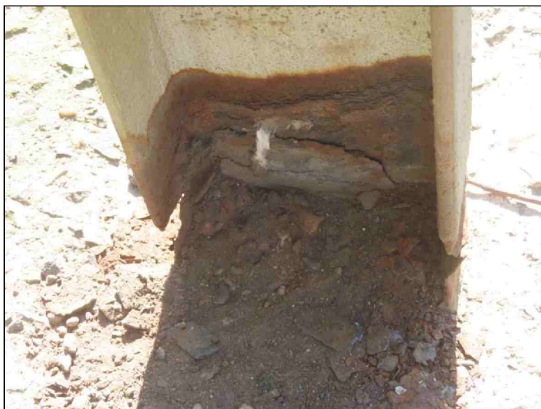
Pravá strana Koroze sloupků- vrstevnatá
