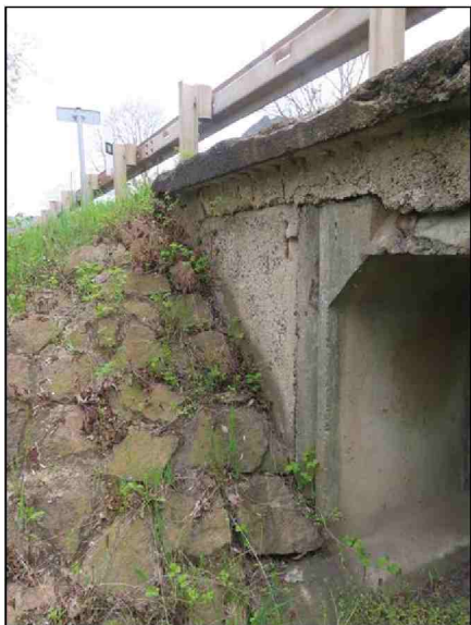
Pohled na OP1 z PS Projevy zatékání pod římsou
