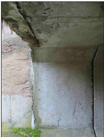
Pohled nad OP2 LS Příčel -projevy silného zatékání pod římsou a separace krycí vrstvy 1 díl
