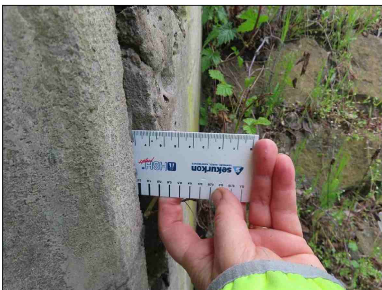
Pohled na OP2 a křídlo z PS křídlo- vyklonění 1,5 cm
