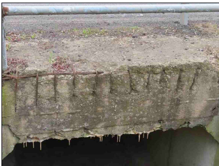
Pohled na most zleva Chybí římsa- zatekání na čelní zed a do podhledu- krápníky Levá čelní zeď - obnažené silně korodující pruty výztuže, hloubková degradace betonu
