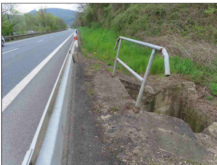
Levá strana za OP2 Zábradlí- vychýlení, koroze, volný konec madla
