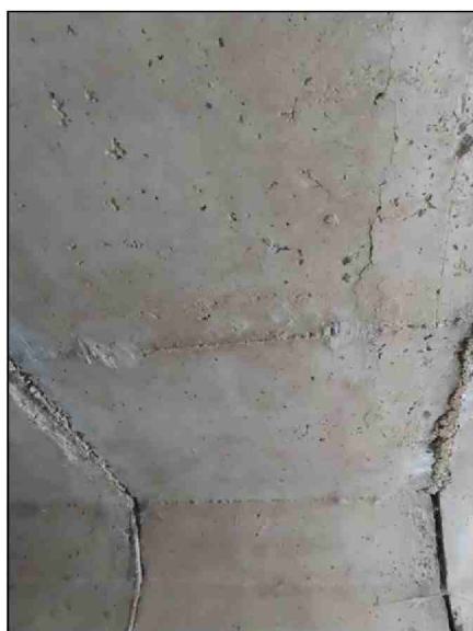
Pohled na OP1 LS 3: díl- horní příčel - separace krycí vrstvy
