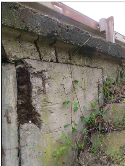
Pohled na OP2 a křídlo z PS křídlo- odpadnutí hrany- obnažena silně korodující výztuž
