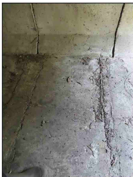
Pohled na OP1 LS 3: díl- dolní příčel - koroze výztuže
