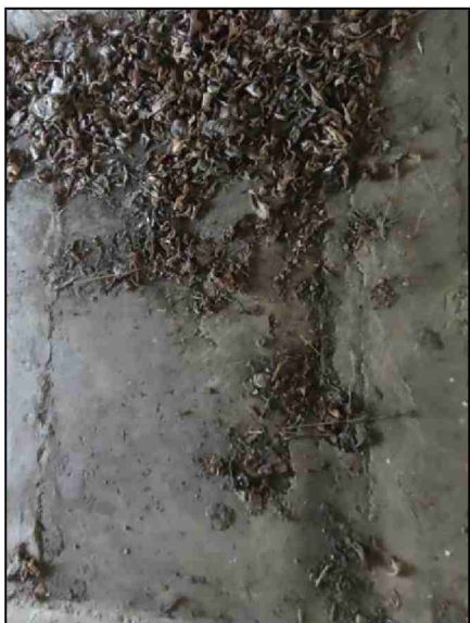
Pohled na 3: díl- dolní příčel - koroze výztuže
