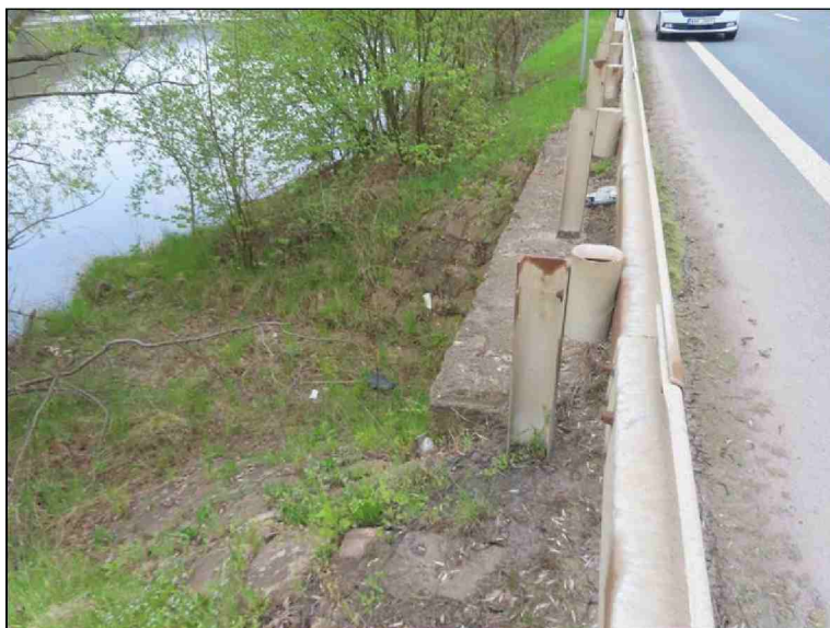
Pohled na římsu zprava nad OP2 Koroze sloupku
