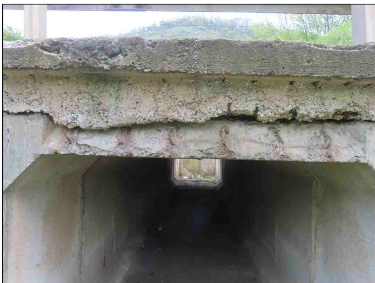
Pohled dobetonávka čela z PS Koroze obnažené výztuže
