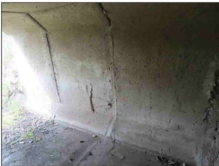
Pohled na OP1 PS 10 díl Separace krycí vrstvy
