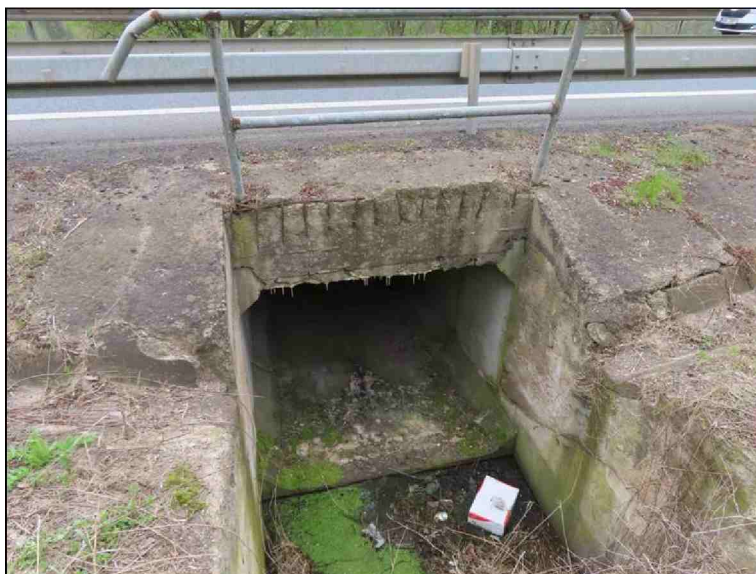
Pohled na most zleva Chybí římsa Levá čelní zeď - obnažené silně korodující pruty výztuže, hloubková degradace betonu Uvolněné zábradlí z kotvení
