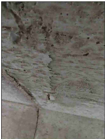
Pohled na příčel 6. díl Separace krycí vrstvy
