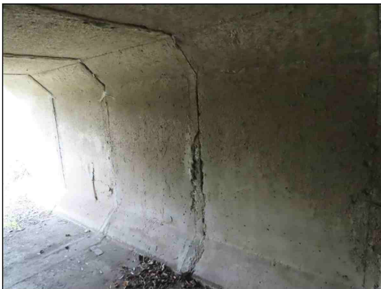
Pohled na OP1 PS 9-11 díl Separace krycí vrstvy
