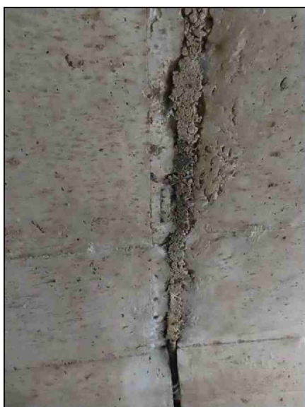
Pohled nad OP1 LS Příčel - stopy po zatékání spárou mezi 4-5 dílem
