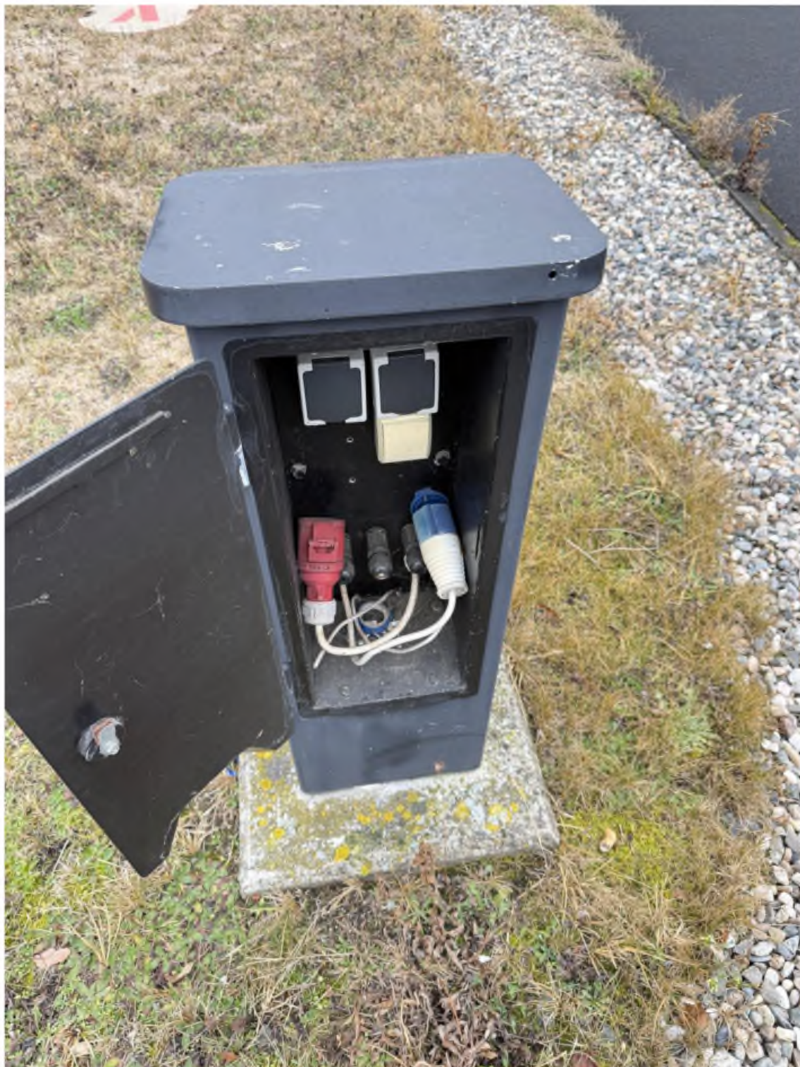
Obr. č.19 – Exteriérové přípojně místo - sloupek
