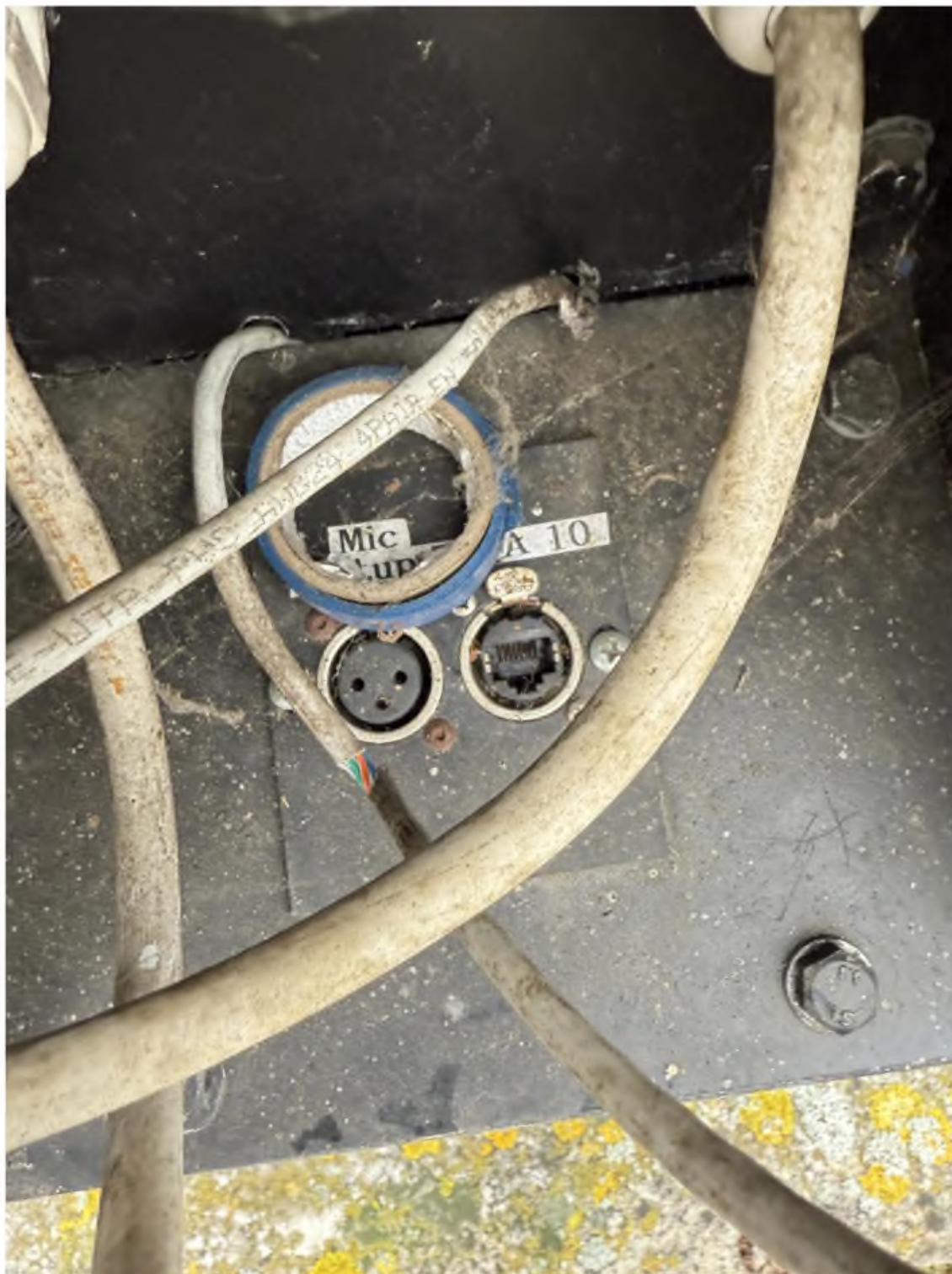
Obr č.20 – Exteriérové přípojně místo – koroze konektorů
