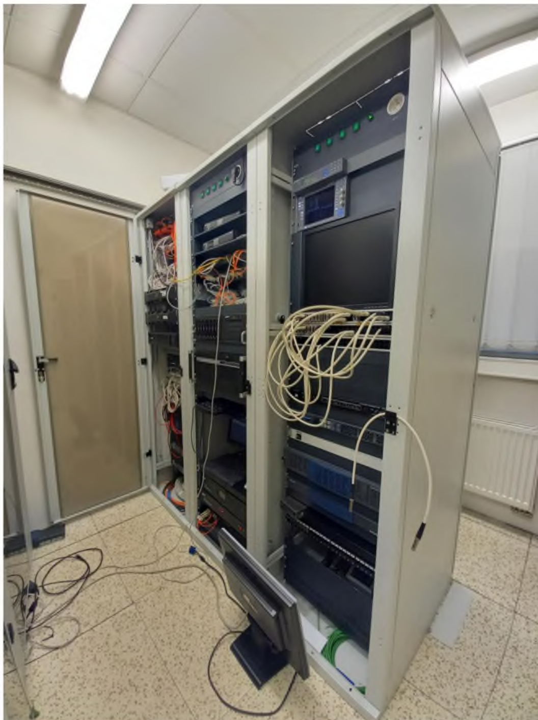
Obr č.1 - Technologické stojany zázemí reže
