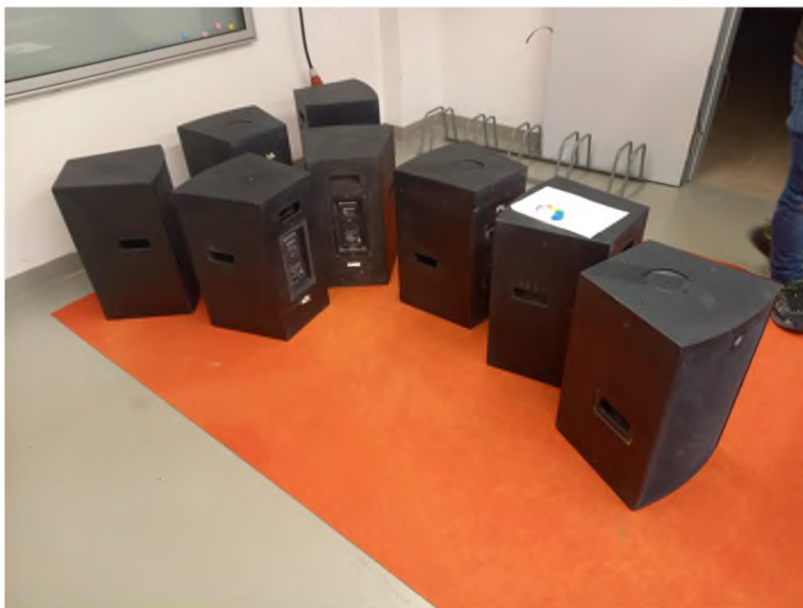
Obr č.7 – demontované exteriérové reprosoustavy
