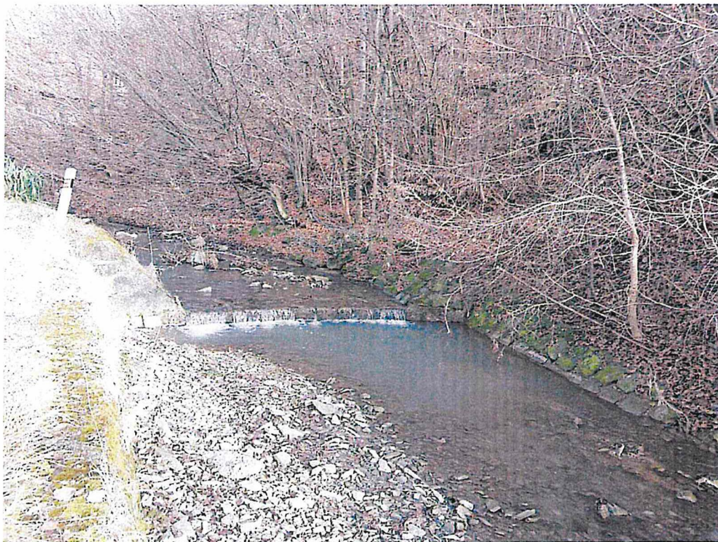
Obrázek 1 Současný stav kamenného stupně v ř. km 0,300 (poškozené těleso stupně, vývar zanesen sedimentem)
