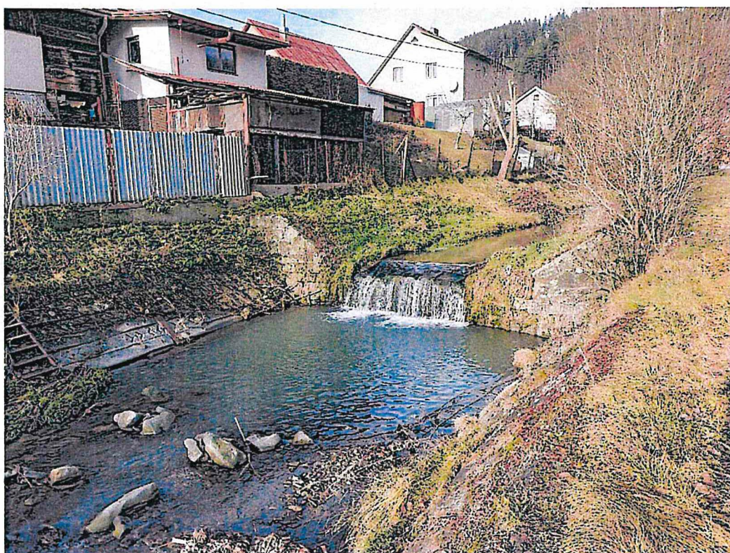
Obrázek 4 Kamenný stupeň v ř. km 0,900 (poškozené těleso stupně včetně přelivné hrany)
