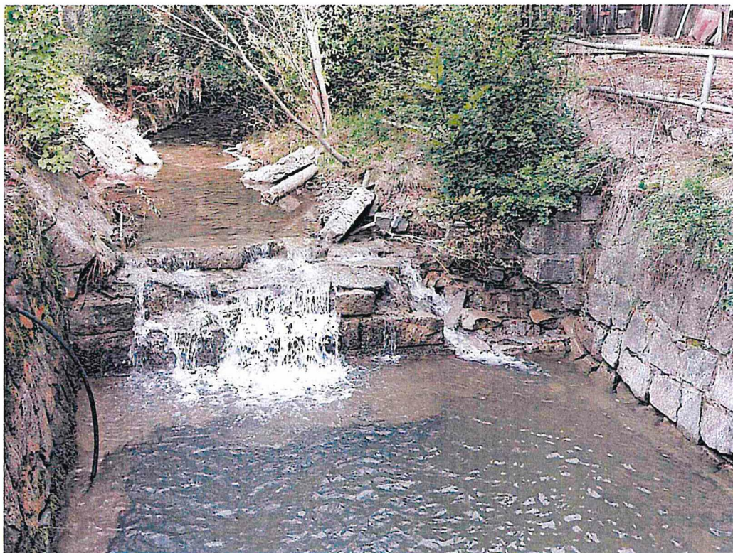
Obrázek 2 Kamenný stupeň v ř. km 0,360 po povodni
