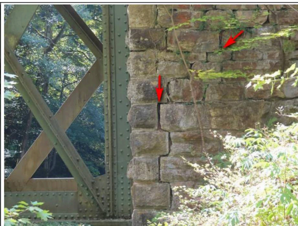
Foto č. 8 - O 02 - závěrná zed' z líce vpravo, odpojení rohových kvádrů svislou trhlina ve spáře, hrozí rozvíjení poruchy. Křídlo má hloubkově vypadané spárování.
