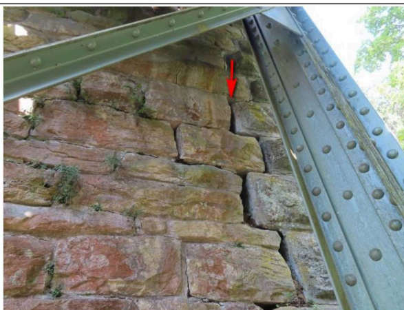
Foto č. 9 - O 02 - závěrná zed' z čela vpravo, odpojení rohových kvádrů svislou trhlina ve spáře, hrozí rozvíjení poruchy.
