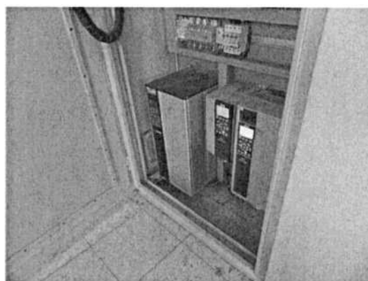
Obrázek 20: Frekvenčně řízené ventilátory
