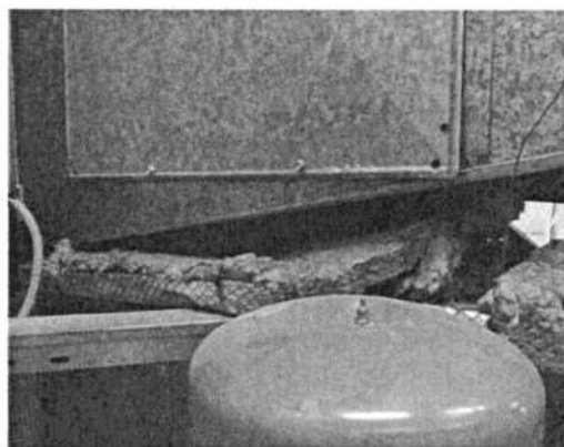
Obrázek 24: Izolace VZT jednotky
