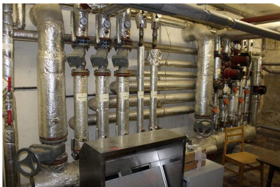
Obrázek 43 - Rozdělovač a sběrač v budově školy
