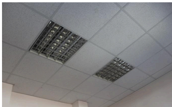
Obrázek 38 - Osvětlení WC - Vedlejší budova ZŠ
