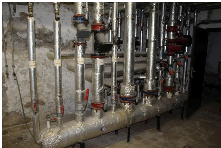
Obrázek 89 - Rozdělovač a sběrač v budově školy
