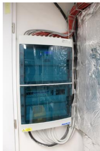
Obrázek 141 - Řídicí jednotka VZT
