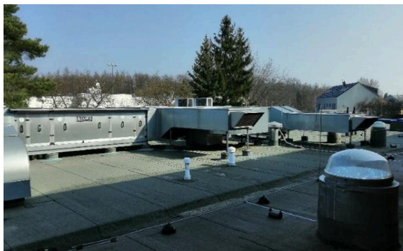
Obrázky 74 – VZT jednotky na střeše
