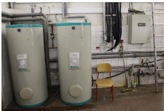
Obrázek 123 - Centrální ohřev TV - Nepřímotopné zásobníky teplé vody
