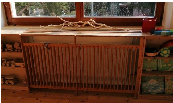
Obrázek 82 - Otopné těleso za dřevěným ohrazením
