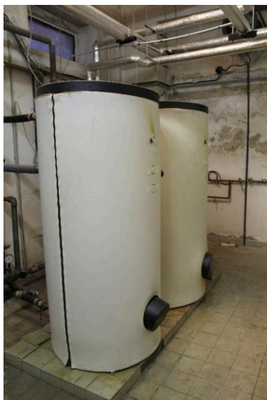
Obrázek 93 - Akumulační zásobníky teplé vody
