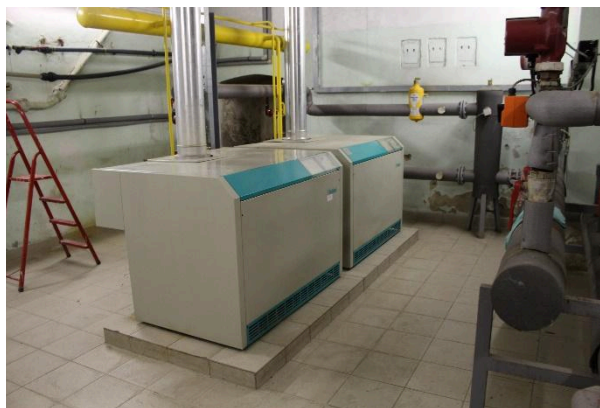
Obrázek 13 - Zdroje tepla - hlavní budova ZŠ
