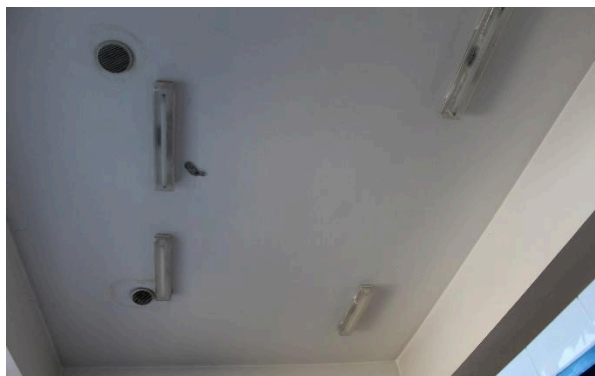
Obrázek 34 - Osvětlení sociálního zařízení hl. budovy
