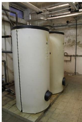
Obrázek 47 - Akumulační zásobníky teplé vody
