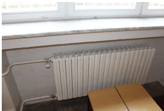
Obrázek 46 - Desková otopná tělesa v budově
