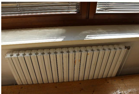
Obrázek 152 - Otopné těleso v tělocvičně, bez TRH
