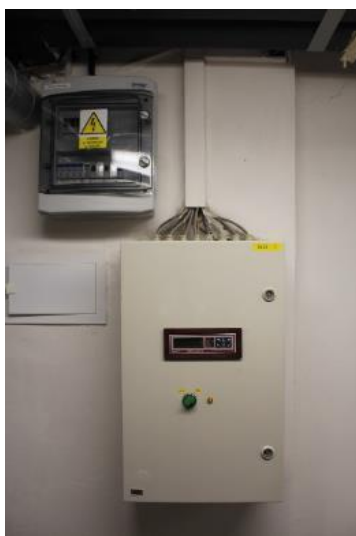
Obrázek 142 - Regulační stanice pro rozdělovač v objektu B
