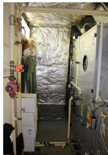
Obrázek 126 - Zařízení č. 1 - VZT jednotka KLM10
