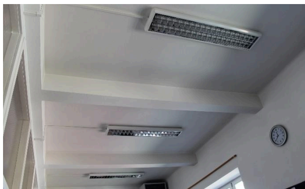
Obrázek 37 - Osvětlení kabinetu - vedlejší budova ZŠ
