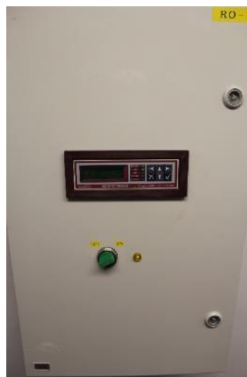
Obrázek 143 - Detail regulační stanice pro rozdělovač v objektu B
