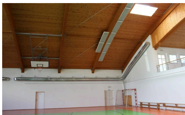
Obrázek 32 - VZT potrubí a distribuce
