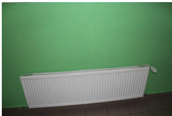
Obrázek 92 - Desková otopná tělesa v budově
