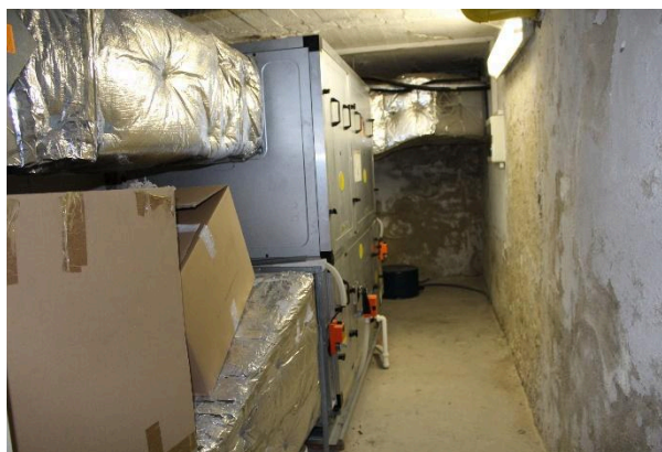
Obrázek 28 - VZT jednotka pro větrání kuchyně v hlavní budově ZŠ
