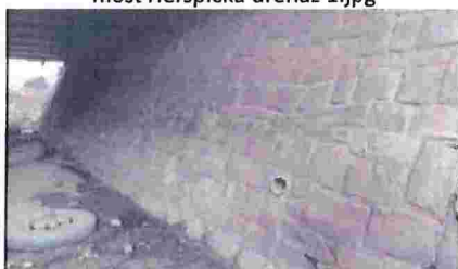
most Heršpická drenáž 1.jpg
