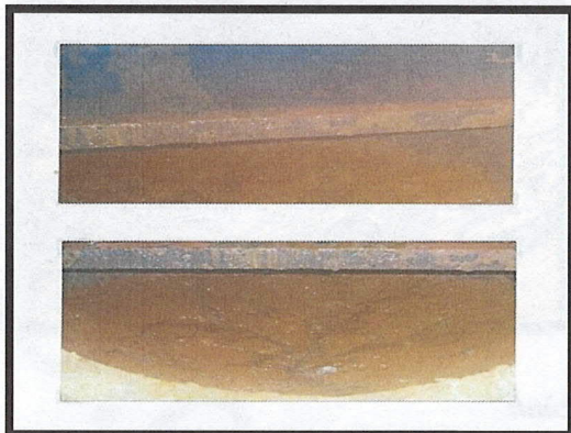
Rozpuštěný kámen v bojleru po čištění:
