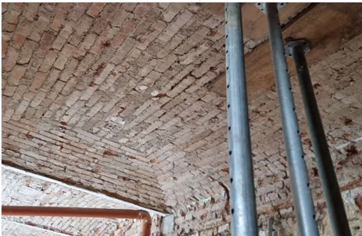
Uvolněné zdivo a vypadaná zdící malta
