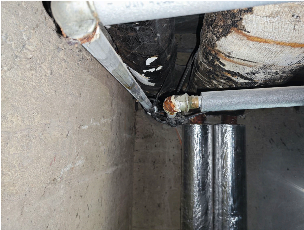
Koroze vodovodního potrubí
