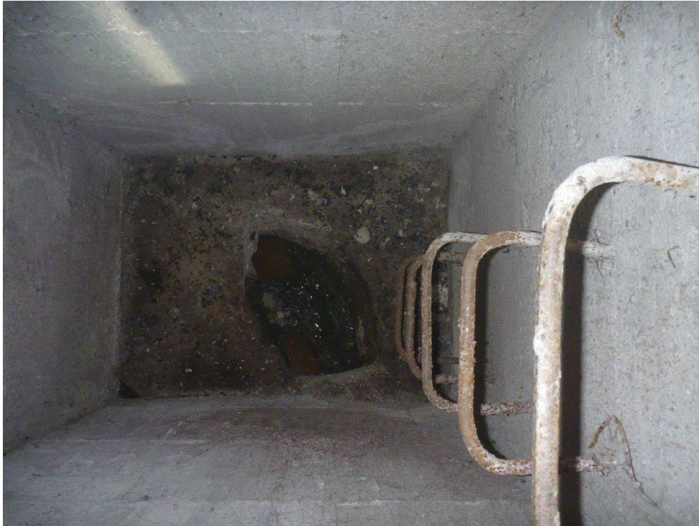
Revizní šachta RŠ1
