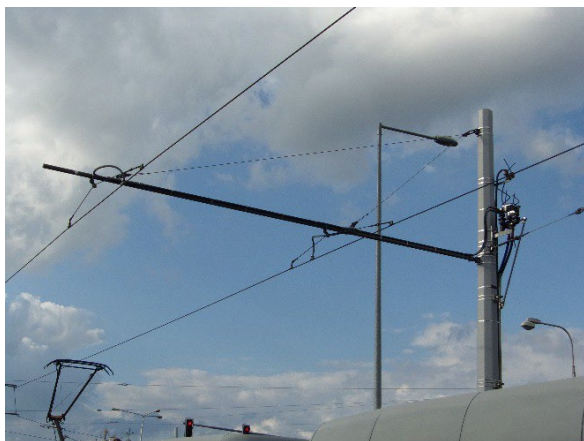
Obr. 42: Propojovací kabely na výložníku
