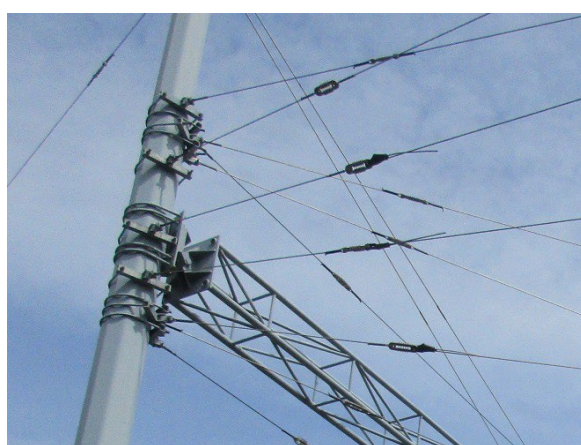
Obr. 24: Trakční vedení na nosné konstrukci
