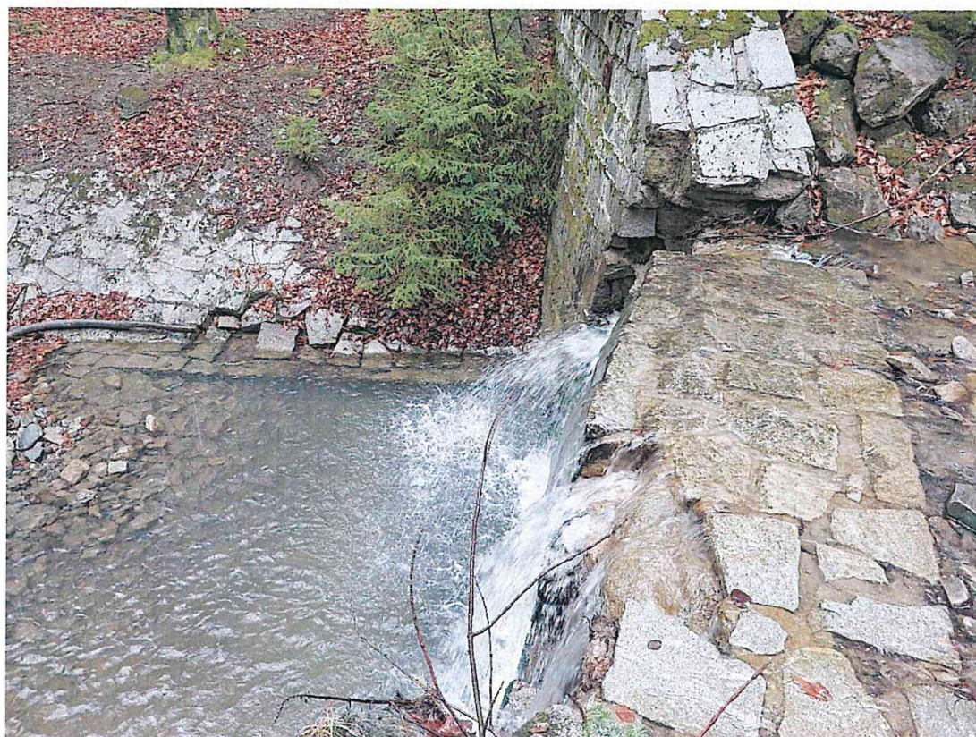
Obrázek 4 Poškozená přelivná hrana
