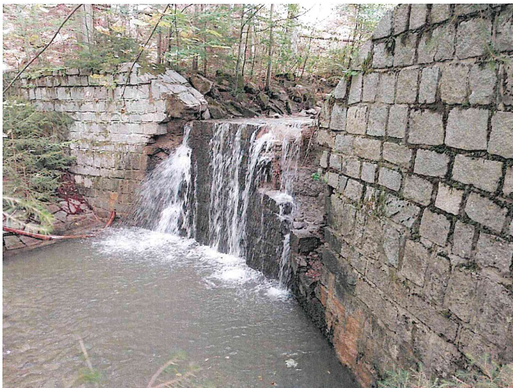
Obrázek 1 Poškozené těleso přehrázky
