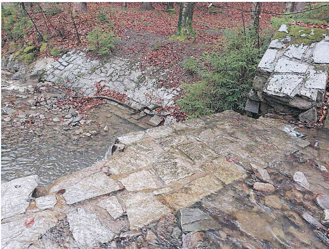
Obrázek 5 Poškozená přelivná hrana
