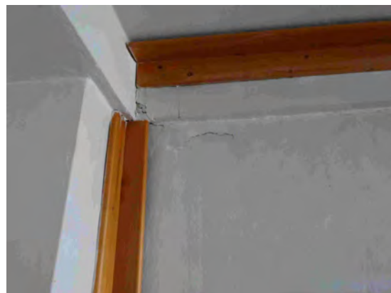
Objekt A – škola - Detail trhliny u sloupu
