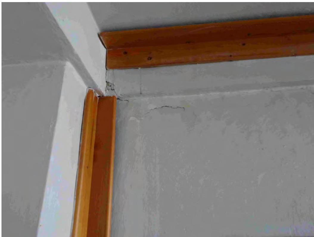
Detail trhliny u sloupu
