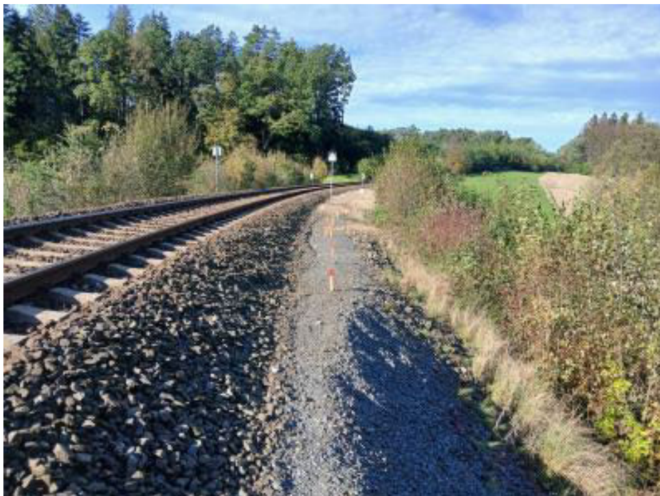
Foto lokality nestabilního úseku tratě TUDU 21 3110 Frenštát pod Radhoštěm – Kunčice, km 88,400 – 88,700
