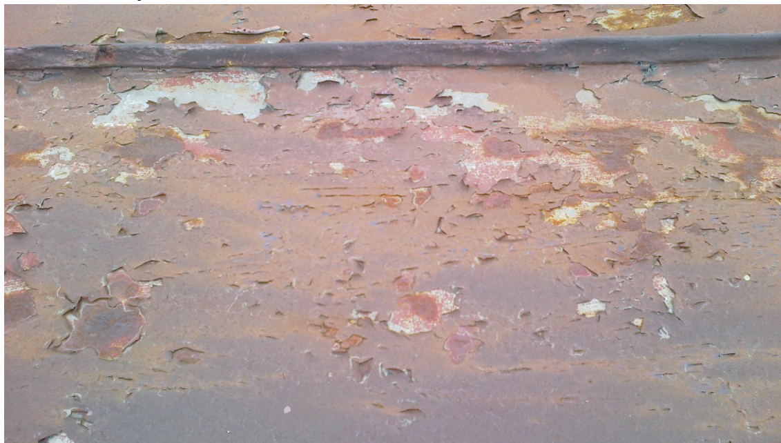
Foto 3: detail povrchové částečné koroze
