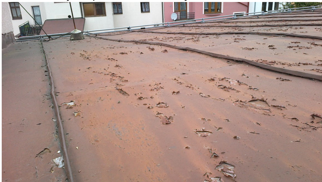
Foto 2: současný stav povrchové části střechy
