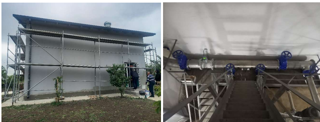
Obr. 17 Fotodokumentace čerpací stanice odpadních vod, fotodokumentace ze dne 27. 05. 2024
