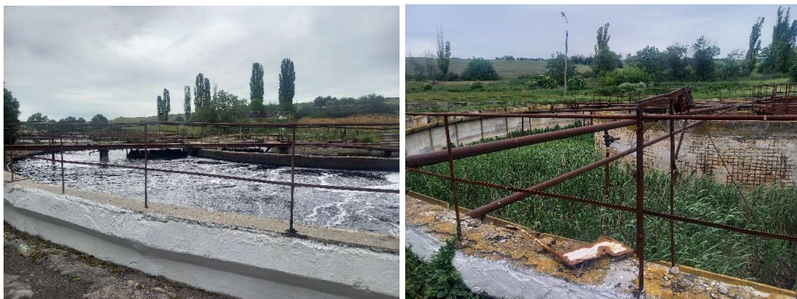
Obr. 7 Fotodokumentace čistírny odpadních vod, fotodokumentace ze dne 27. 05. 2024
