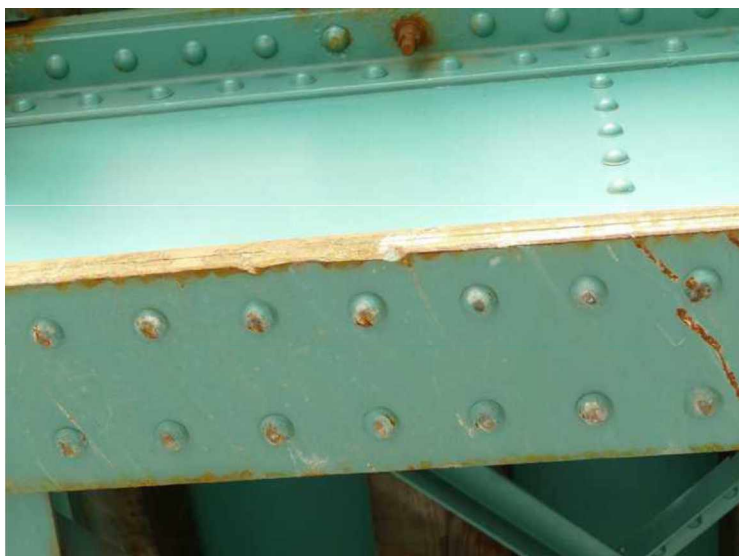
Konstrukce K 01: Hlavní nosník vpravo dolní pásnice, vruby
