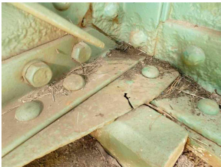
Konstrukce K 01: Příčné ztužení na začátku, styčnickový plech, prokorodování
