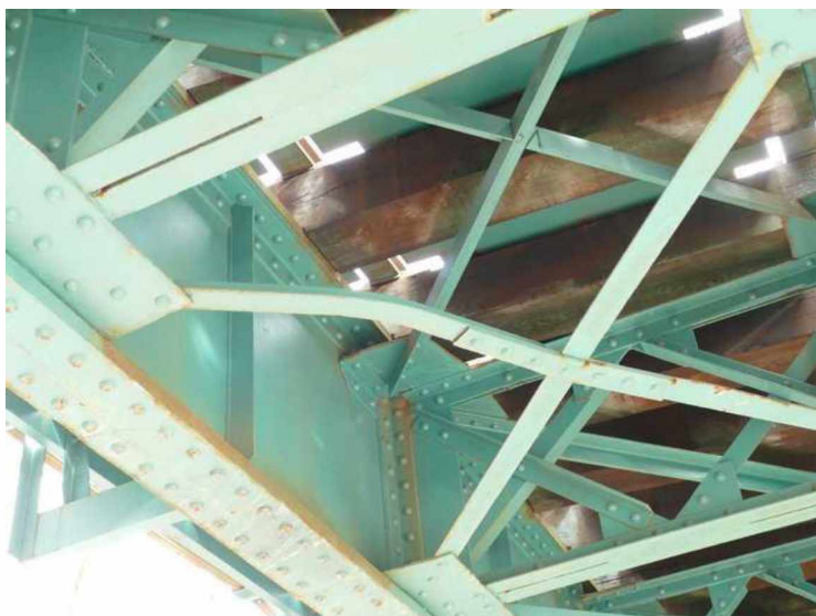
Konstrukce K 01: Příčné ztužení, deformace
