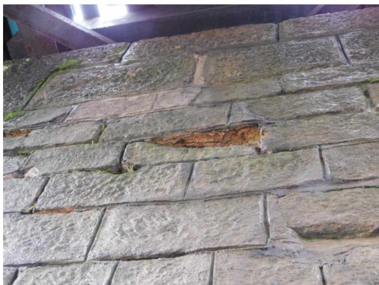
Opěra O 01: dřík – vodorovná trhlina, zvětralý kámen
