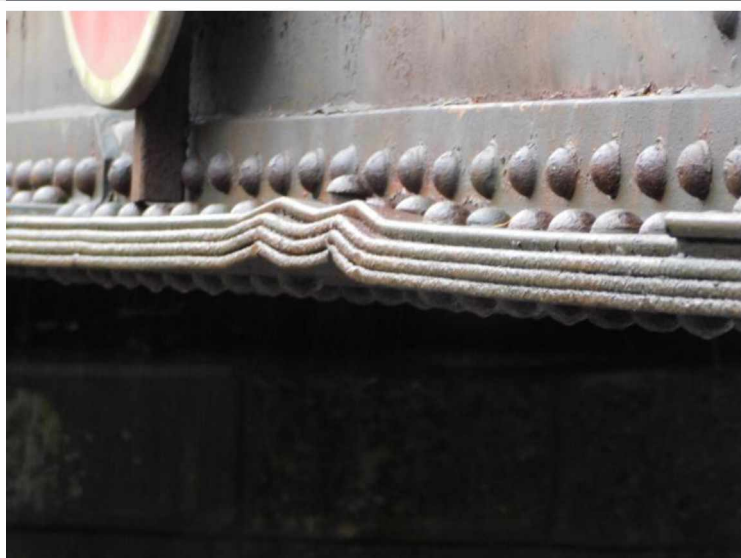
Konstrukce K 01: levý hlavní nosník – deformace dolního pásu ve 3. poli
