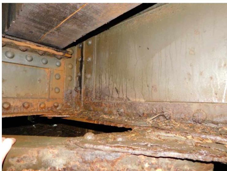
Konstrukce K 01: korozní oslabení 1. příčnicku
