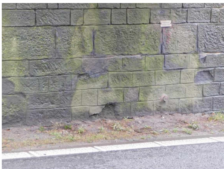
Opěra O 02: dřík – zvětralí kameny v dolní části
