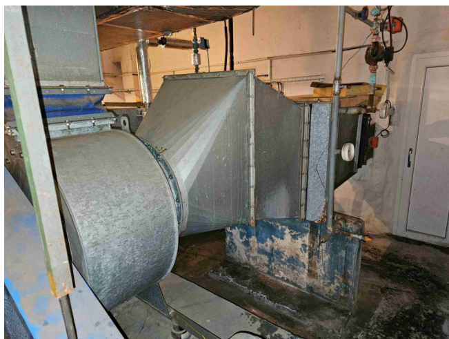
Kuchyně – přívodní zařízení
