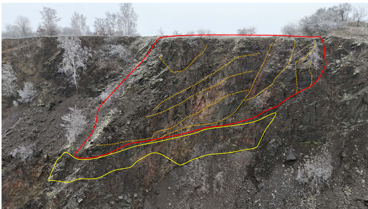
Obrázek 5: čelní pohled na rizikový masiv, červená linie vymezuje hlavní nestabilní masiv stěny bývalého lomu výšky 10 – 16 m, žlutá linie vymezuje narušenou a labilní podstavu, tečkované linie vyznačují měřené poruchové plochy odlučnosti s měřeným vysunutím horních částí nad spodní o 2 – 6,5 cm.
