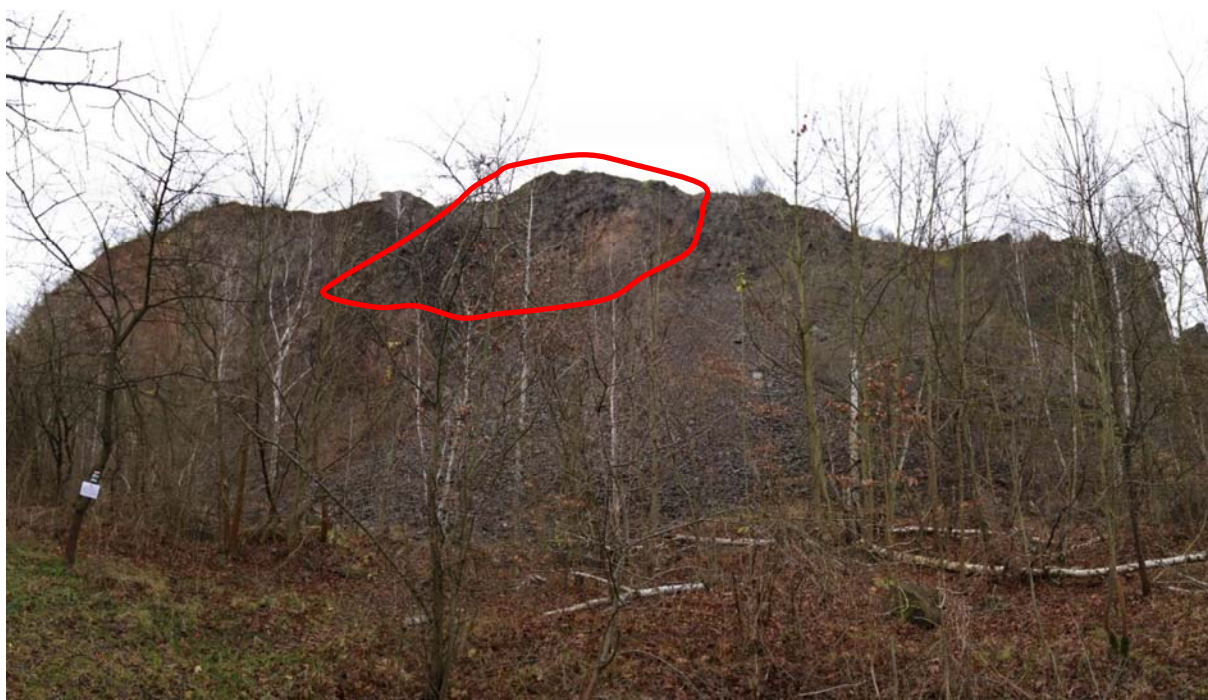
Obrázek 12: pohled na strmou skalní stěnu s vyznačením pozice nestabilní masy horniny ve vysoké lokaci
