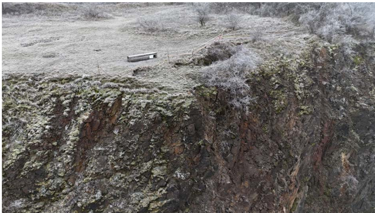
Obrázek 15: pohled na horní partie a významné projevy svahové nestability masivu, poklesy a oddělení masivu na horní hraně dosahují řády až jednotek metrů
