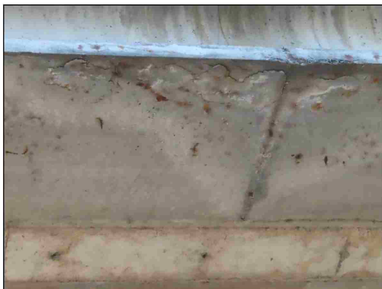
Pohled směrem k OP1 zprava do 1. pole 8. nosník- bok a spodní líc Projevy zatékání pod římsou Separace krycí vrstvy-
