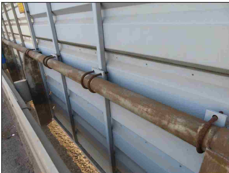
Levá strana 2. pole Protidotyková zábrana- koroze uchycení
