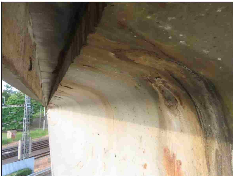
Pohled od OP1 zleva Nosník č. 1 ( krajní) Zatékání pod římsou- separace krycí vrstvy
