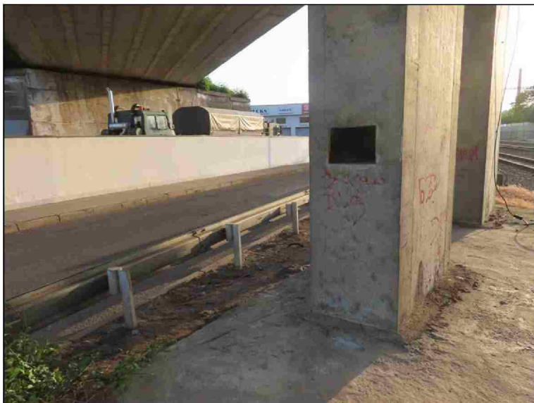
Pohled Pi2 zprava ze 2. pole Nezakrytý otvor stálého zařízení
