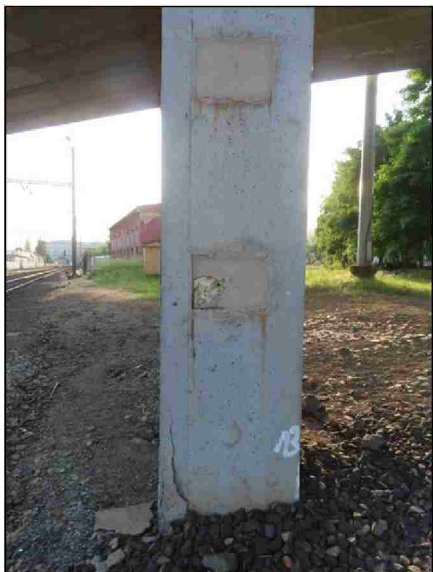
Pohled na Pi3 zprava ze 2. pole Pravá stojka- odštěpené hrany
