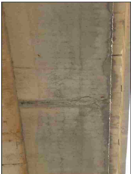
Pohled na spodní líc NK zleva 1.pole směrem k OP1 1 nosník- separace krycí vrstvy
