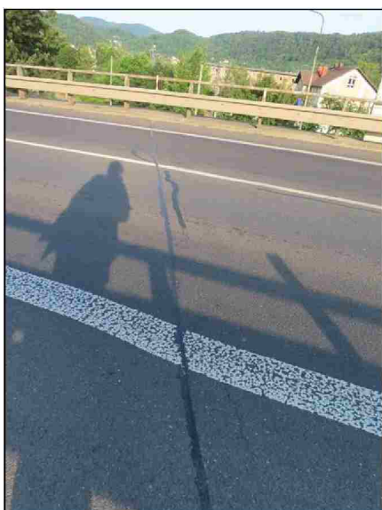
Dilatační spára nad OP4 z LS Šikmá trhlina
