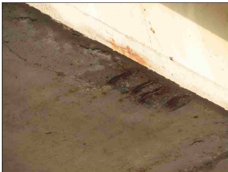
Pohled na spodní líc NK zleva 1.pole Zatékání pod řimsou- separace krycí vrstvy, obnažené pruty
