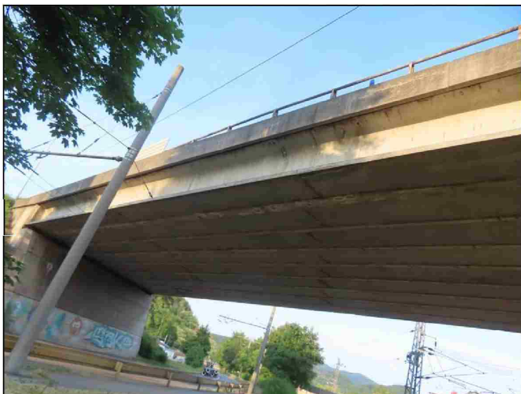
Pohled od Pi3 zleva do 3. pole Zatékání spárou mezi 1-2. nosníkem
