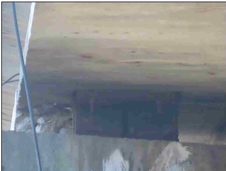
Pohled na Pi2 zprava a do 2. pole 8.ložisko- válcové
