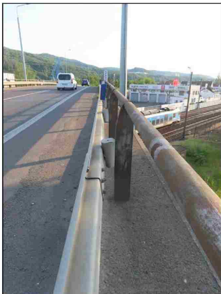
Levá strana 3. pole Zábradelní svodidlo- deformace
