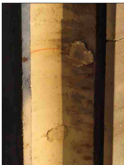
Pohled od OP4 zleva Separace krycí vrstvy nad vozovkou
