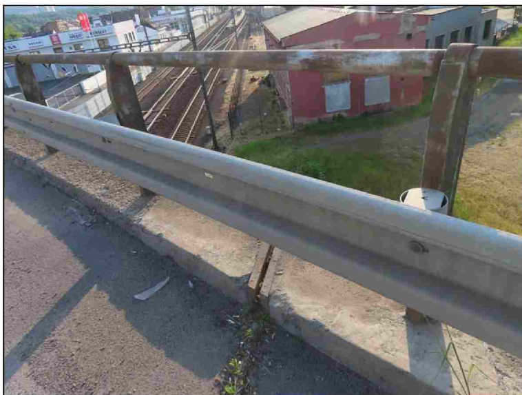
Nad MZ Pi3 LS Zábradelní svodidlo-- není osazen dilatační díl
