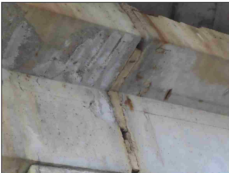
Pohled na Pi3 zleva ze 2. pole Stativo- středová spára- porušená výplň
