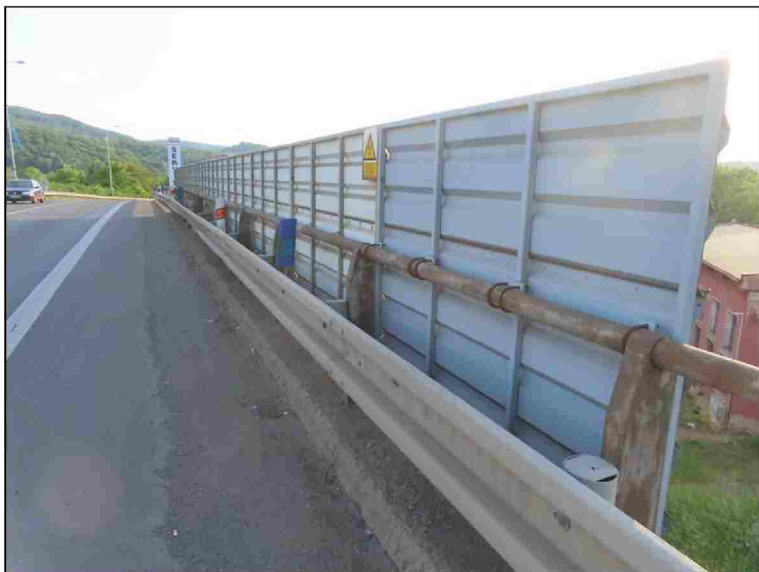
Levá strana 2. pole Protidotyková zábrana
