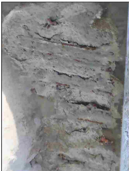
Pohled na Pi3 zleva ze 2. pole Spodní líc stativa na levou stojkou- po sanaci opět separace
