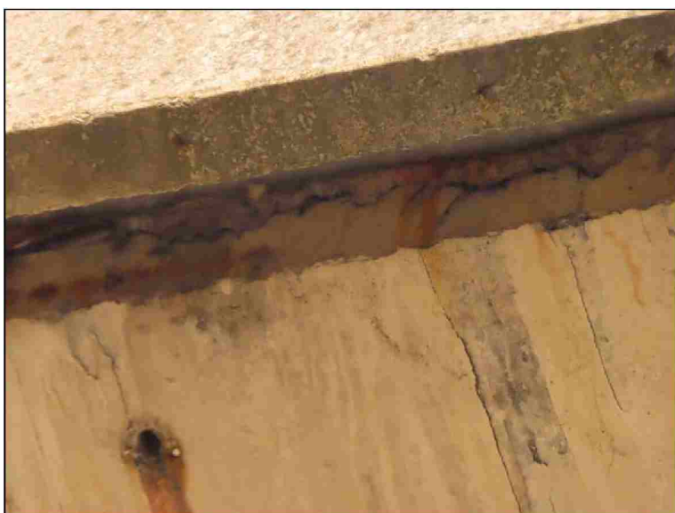
Pohled od Pi2 zleva do 2. pole 1 nosník- separace krycí vrstvy
