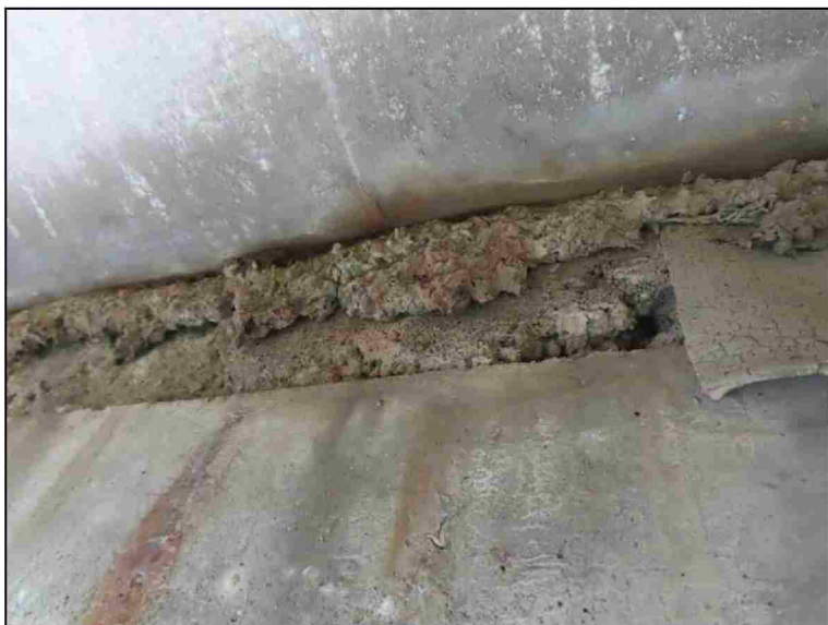
Pohled od OP1 zleva Vyrovnávací deska-nekvalitní beton- možnost separace úlomků Ochrana izolace
