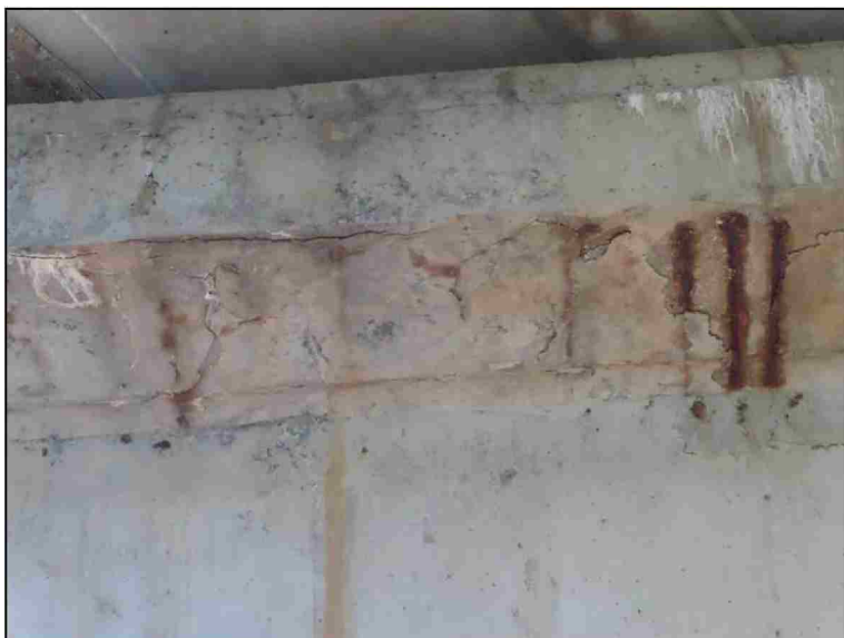
Pohled na Pi3 zprava ze 2. pole Stativo spodní líc - separace
