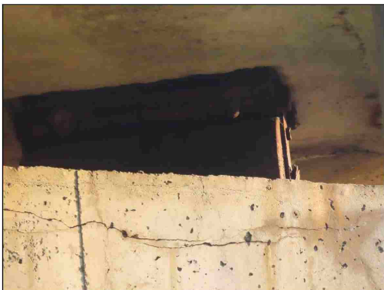
Pohled na Pi3 zleva ze 3. pole 1. ložisko - válcové - povrchová koroze Stativo- trhliny podél horní hrany
