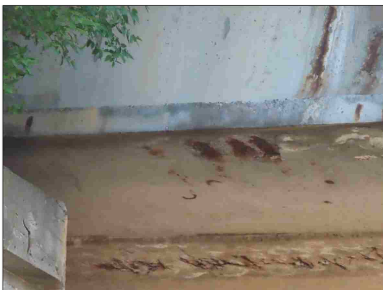
Pohled směrem k OP1 zprava do 1. pole 8. nosník- spodní líc Projevy zatékání pod římsou Separace krycí vrstvy, silná koroze výztuže
