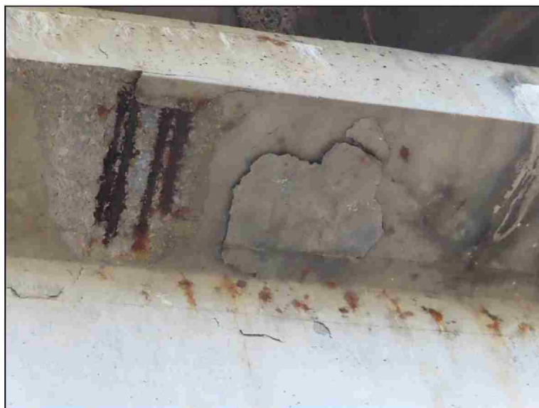
Pohled na Pi3 PS ze 2. pole Spodní líc stativa-separace krycí vrstvy
