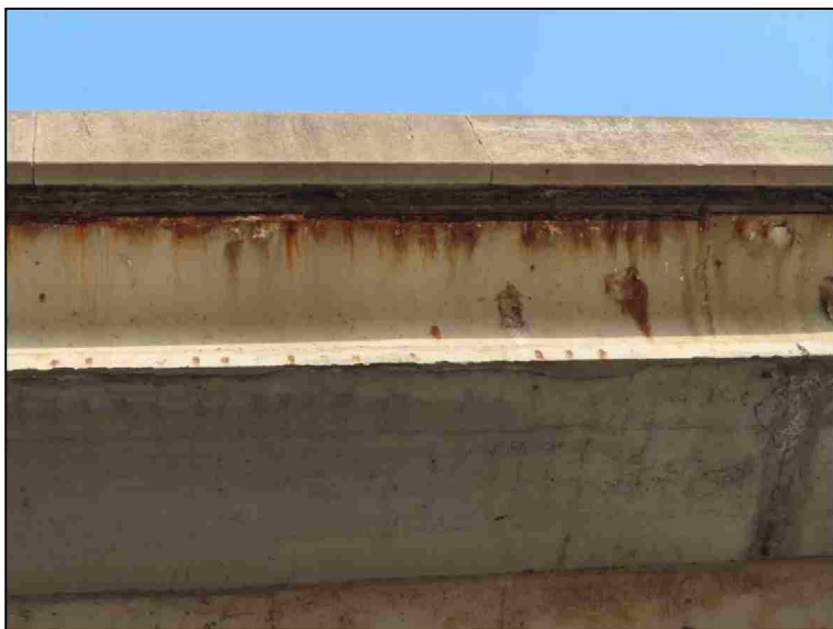
Pohled na boční líc NK zleva 1.pole Zatékání pod římsou- separace krycí vrstvy
