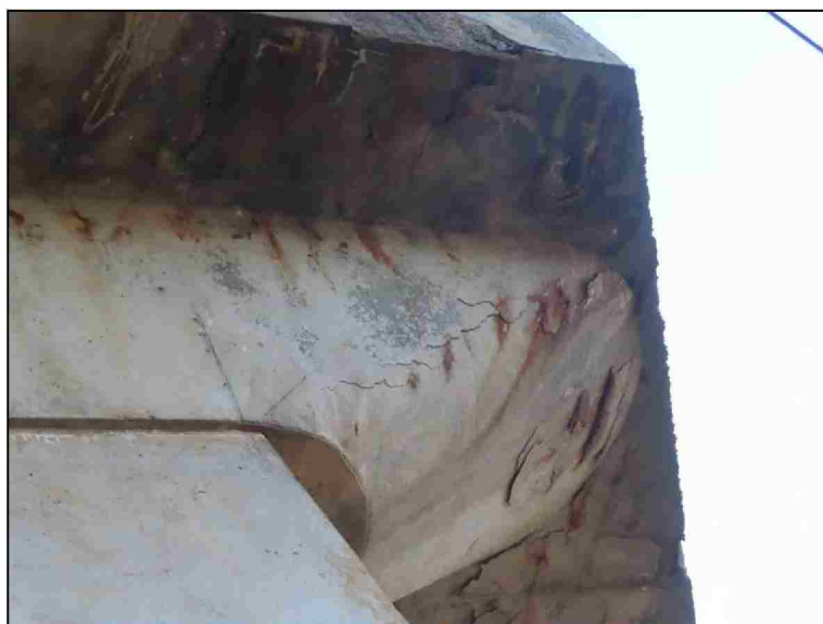
Pohled na Pi3 PS ze 2. pole Spodní líc stativa-separace krycí vrstvy, obnažené sině korodující pruty
