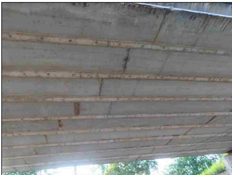
Pohled od Pi3 zprava do 3. pole 8. nosník- separace krycí vrstvy
