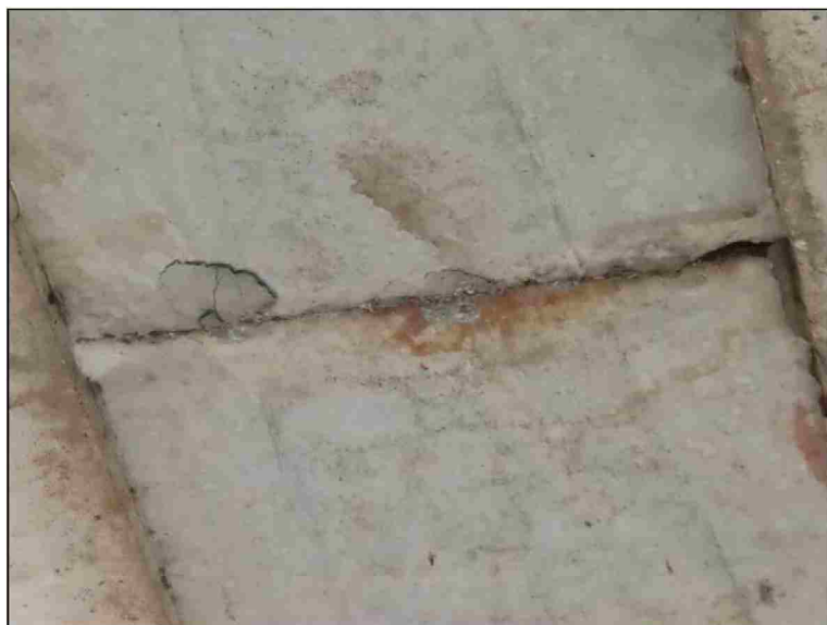
Pohled směrem k OP1 zprava do 1. pole 5. nosník- spodní líc Otevřená pracovní spára Separace krycí vrstvy
