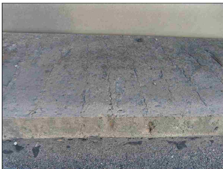
Pravá strana 1. pole Římsa-trhliny
