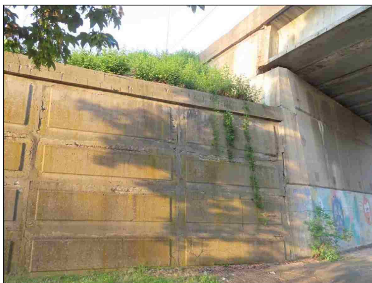
Pohled na OP4 zleva Zatékání dilatační spárou a pod římsou
