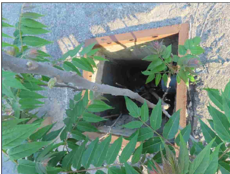
Pravá strana za OP4 Šachta - chybí poklop, náletová dřevina
