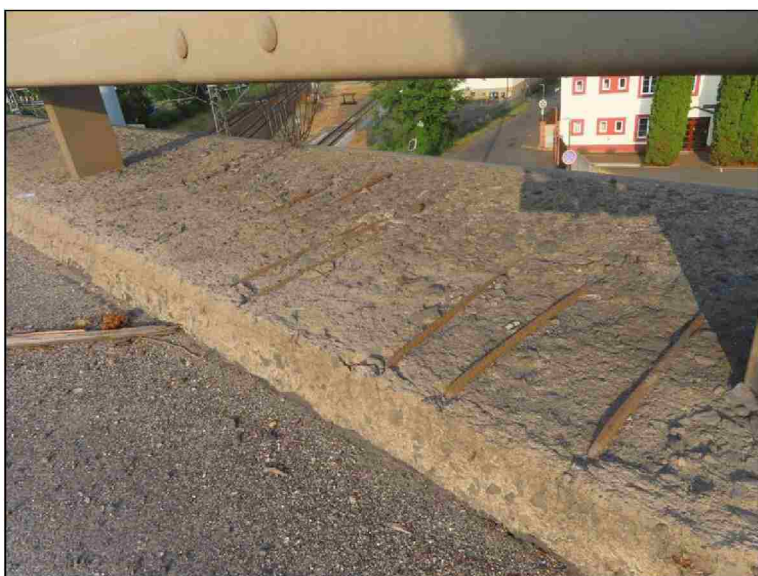
Pravá strana 1.pole Řimsa - obnažené pruty
