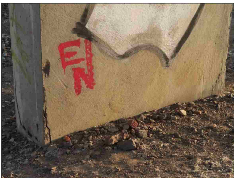
Pohled na Pi3 zprava ze 3. pole Středová stojka- odštěpené hrany
