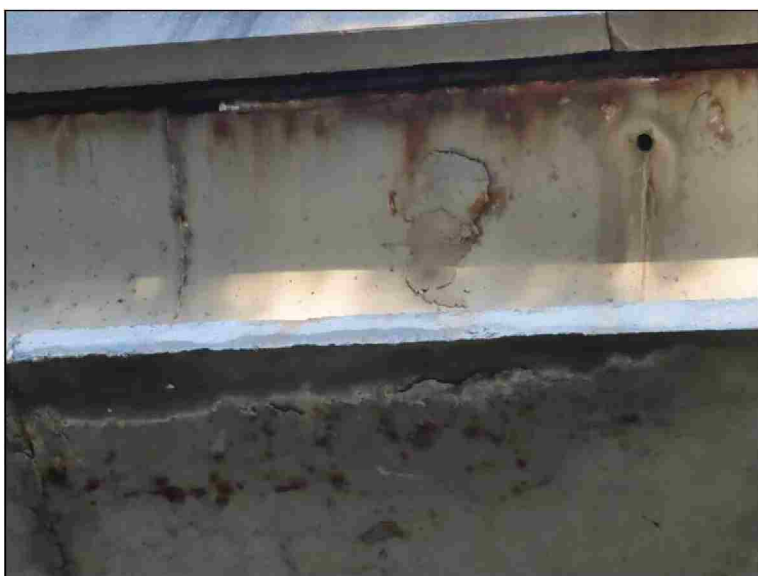
Pohled od Pi3 zleva do 3. pole 1. nosník- bok a spodní líc Projevy zatékání pod římsou Separace krycí vrstvy
