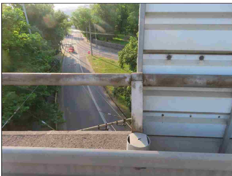
Levá strana 3. pole Protidyková zábrana- krátká
