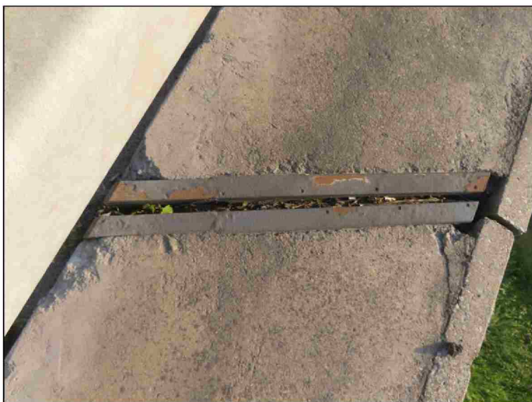
MZ Pi3 LS Koroze lamel Římsa - drcení okraje
