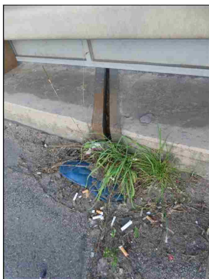
MZ Pi3 PS Koroze lamel , nánosy v mezeře
