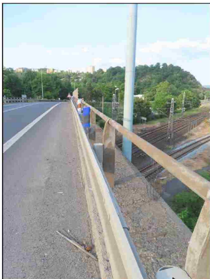
Pravá strana 1.pole a nad Pi2 Zábradelní svodidlo-- koroze madla a sloupků
