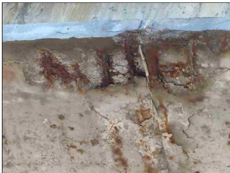
Pohled směrem k OP1 zprava do 1. pole 8. nosník- bok a spodní líc Projevy zatékání pod římsou Separace krycí vrstvy- silně korodující výztuž
