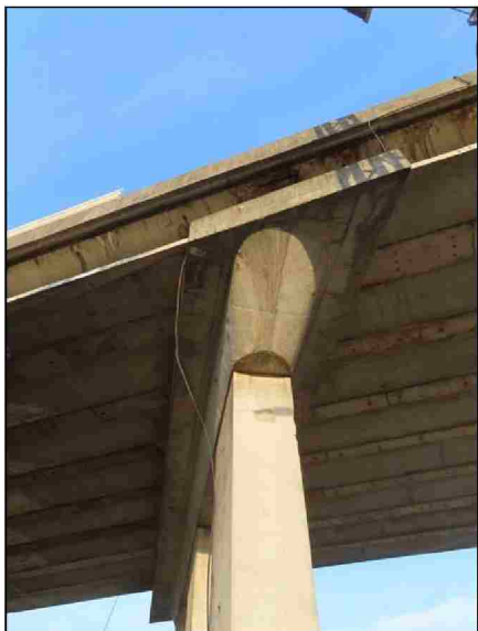
Pohled na Pi2 zleva Stativo - spodní líc - zatékání
