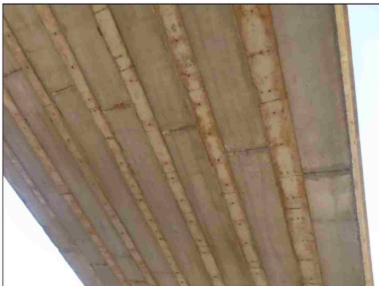
Pohled na spodní líc NK zleva 1.pole směrem k OP1 Pracovní spáry- separace krytí
