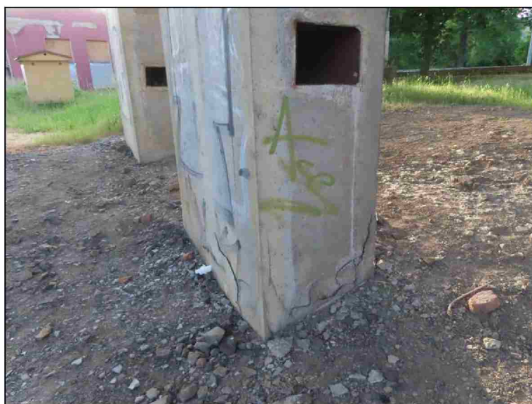
Pohled na Pi3 zprava ze 2. pole Středová stojka- odštěpené hrany
