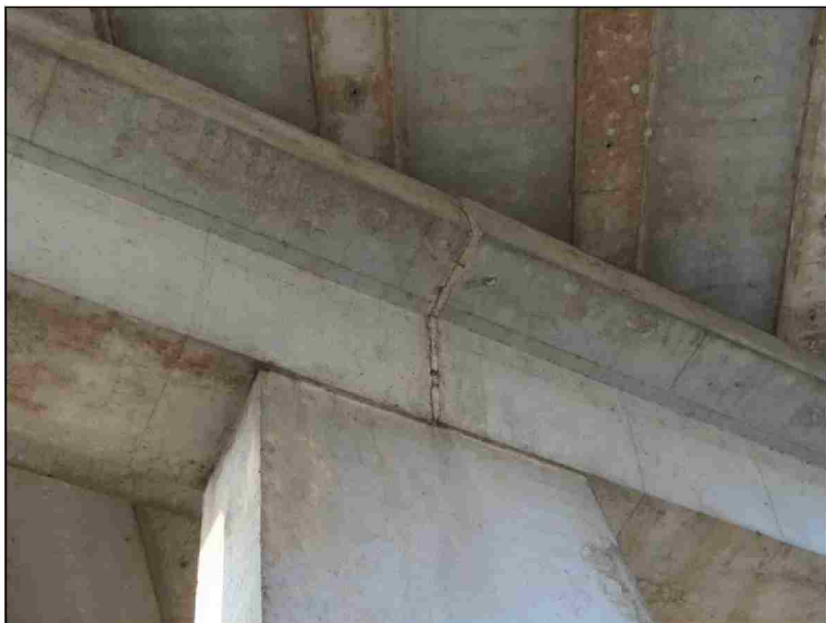
Pohled na Pi2 zleva 1. pole Porušená výplň spáry
