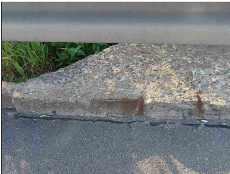
Levá strana nad OP1 Obrubníková část římsy- koroze prutů, uvolněný prut
