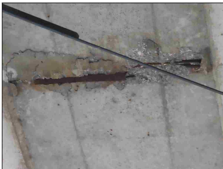
Pohled do 3. pole 5. nosník- pracovní spára- separace krycí vrstvy
