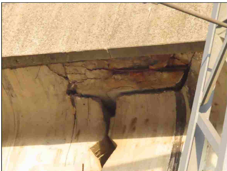
Pohled nad Pi2 zleva 2. pole Dobetonávka mezi nosníky- separace krycí vrstvy
