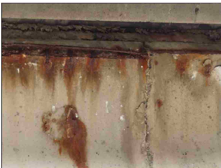
Pohled na boční líc NK zleva 1.pole Zatékání pod římsou- separace krycí vrstvy Uvolněn krajní prut nosníku
