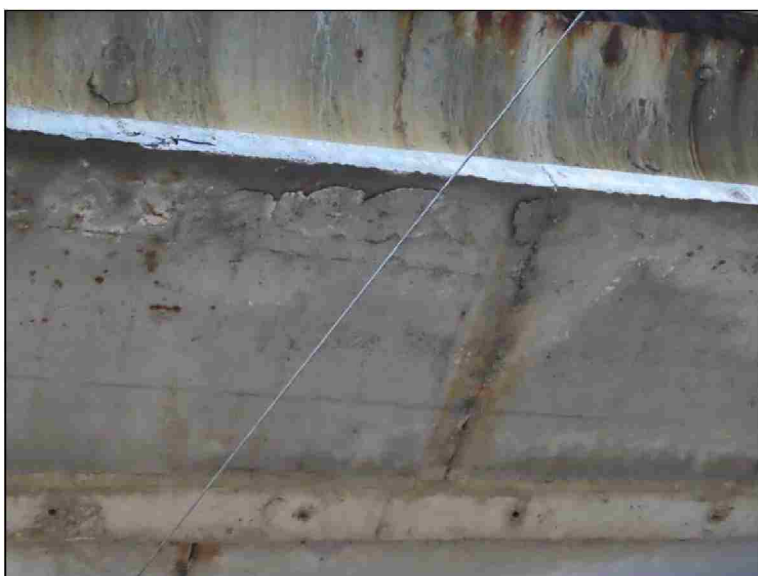
Pohled od Pi3 zprava do 3. pole 8. nosník- separace krycí vrstvy nad vozovkou
