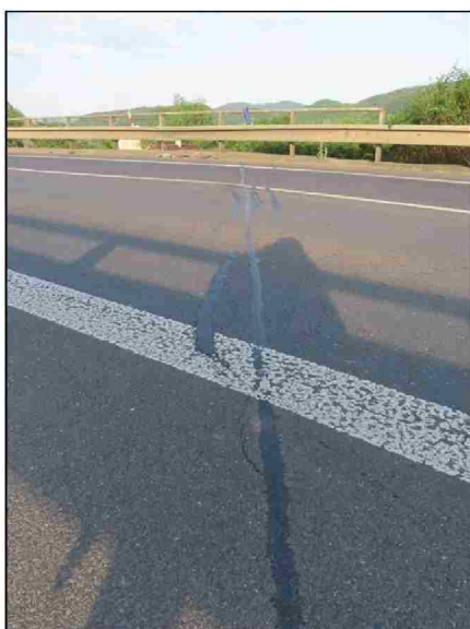
Dilatační spára nad OP1 z LS Vozovka - další příčné trhliny, koleje
