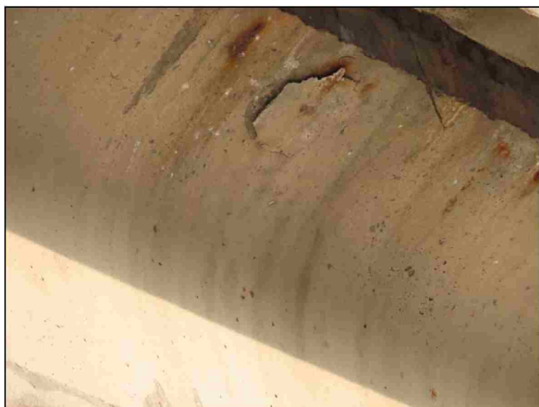
Pohled na boční líc NK zleva 1.pole Zatékání pod řimsou- separace krycí vrstvy Uvolněn krajní prut nosníku
