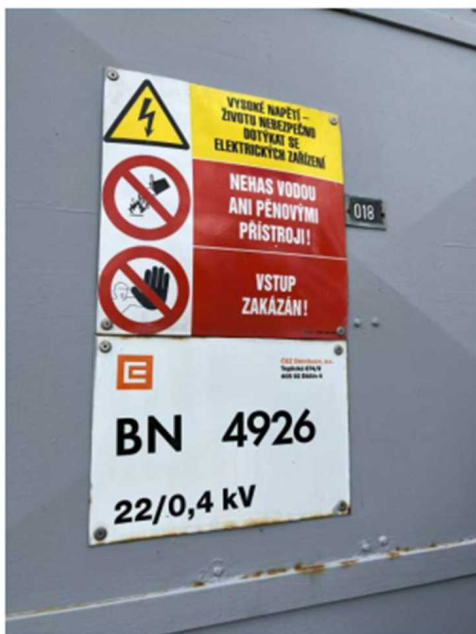
Trafostanice – napojení na DS v úrovni VN (bez možnosti přístupu)
