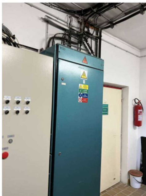
Hlavní rozvaděče areálu
