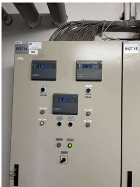
Hlavní rozvaděč - kompenzace
