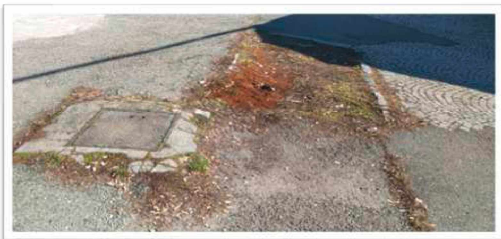
Foto č.5: ŽST Zlín Střed – Nedopalky a rozbitá dlažba u VB.
