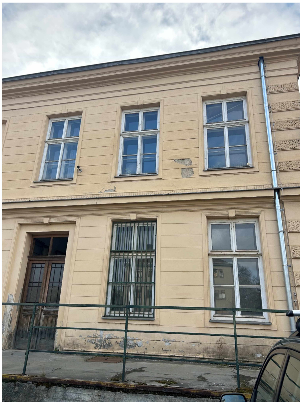
Omítka na fasádě u mašinky
